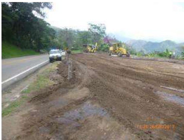
Explanación irregular Km 64+950
