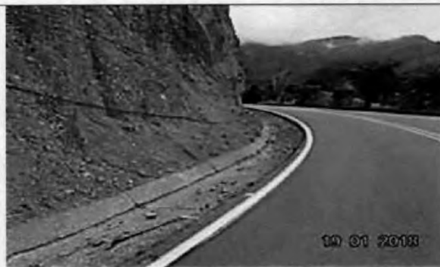
Foto 26. K13+040 al K13+100, falta limpieza de cuneta, costado izquierdo.
