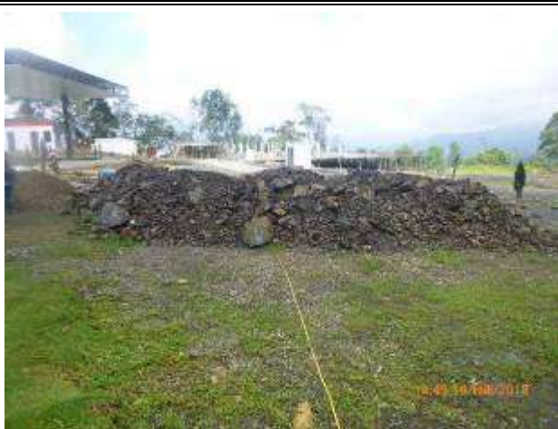
Material sobre el derecho de vía Km 88+310
