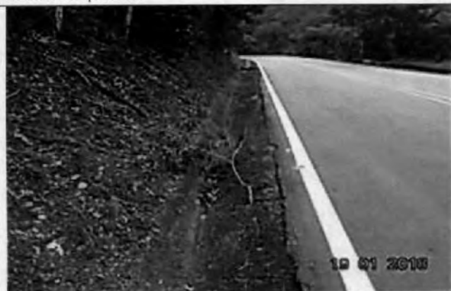
Foto 15. K8+390 al K8+420, falta limpieza de cuneta, costado izquierdo.
