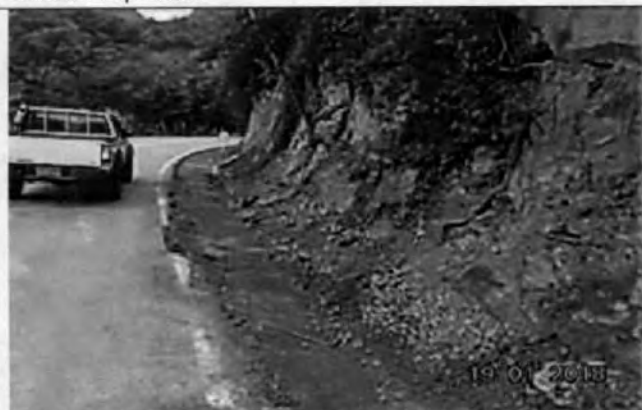
Foto 27. K15+325, retiro de rocas, costado derecho. Reparar cuneta.
