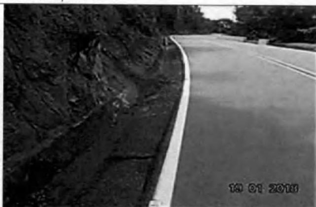
Foto 10. K6+640 al K6+920, falta limpieza de cuneta, costado izquierdo.
