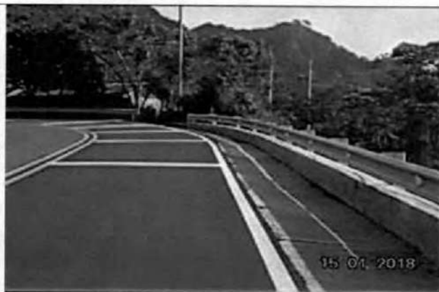
Foto 8. Borde de via sin tachas reflectivas, Tramo Cambao – Chuguacal.
