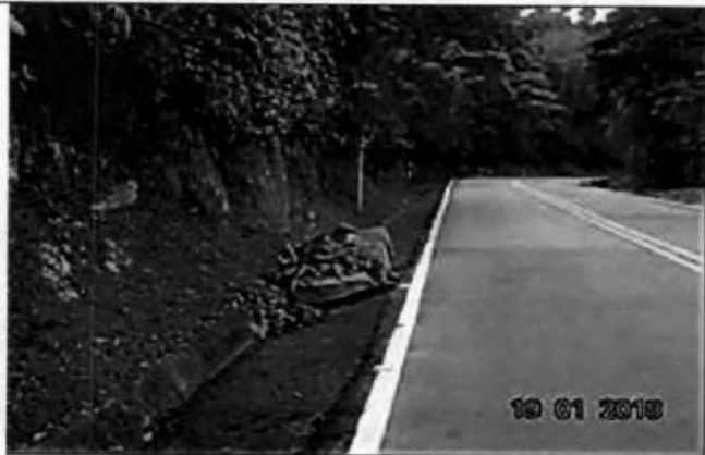
Foto 33. K31+140, falta retiro de rocas, costado izquierdo.
