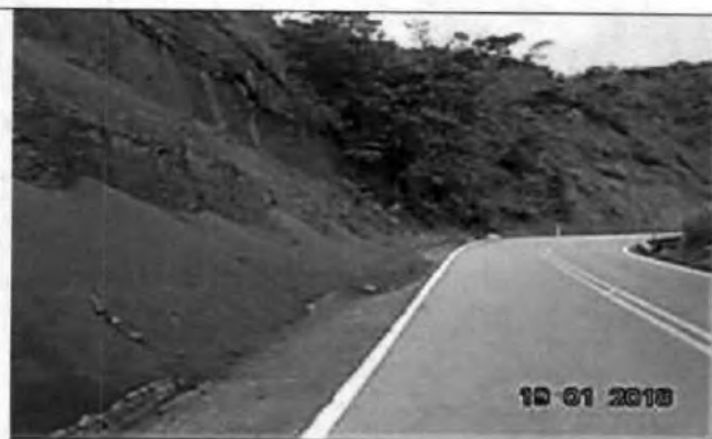
Foto 31. K26+821 al K26+950, falta limpieza de cuneta, costado izquierdo.
