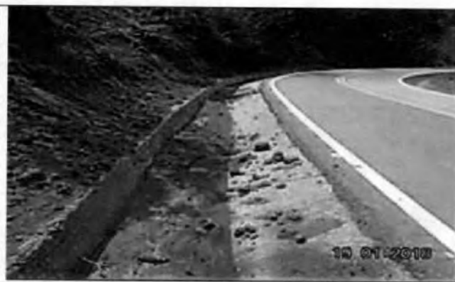
Foto 8. K6+120 al K6+170, falta limpieza de cuneta, costado izquierdo.
