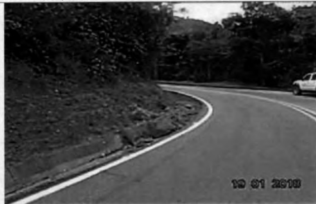
Foto 16. K10+000 al K10+080, falta limpieza de cuneta, costado izquierdo.
