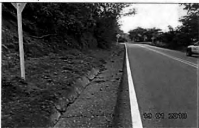
Foto 24. K12+240 al K12+280, falta limpieza de cuneta, costado izquierdo.
