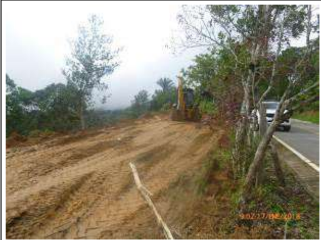
Explanación irregular Km 08+310
