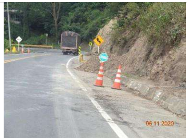
K69+340 Remoción de derrumbe C.D A-V
