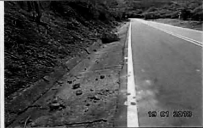
Foto 6. K5+630 al K5+760, falta limpieza de cuneta, costado izquierdo.
