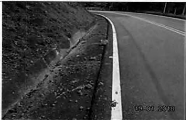
Foto 21. K11+620 al K11+660, falta limpieza de cuneta, costado izquierdo.
