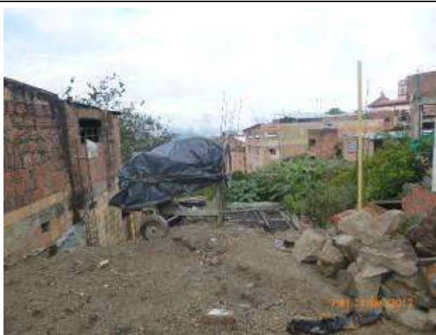
Construcción irregular Km 66+110
