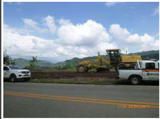
Explanación irregular Km 64+950
