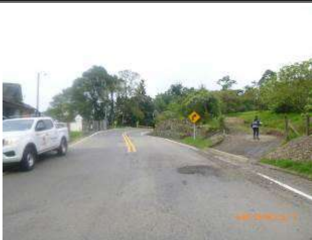
Acceso irregular Km 69+350
