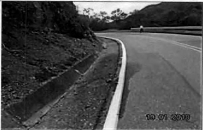
Foto 11. K7+048 al K7+250, limpieza de cuneta, costado izquierdo. Reparar bordillo.
