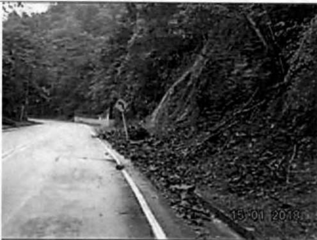
Foto 10. K60+480, Derrumbe, Margen Derecha
