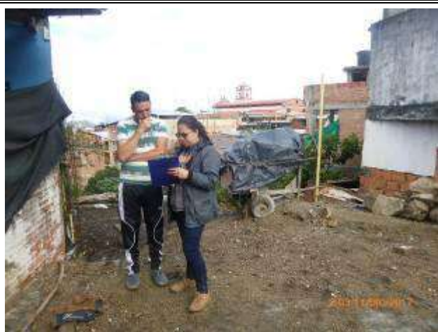
Construcción irregular Km 66+110
