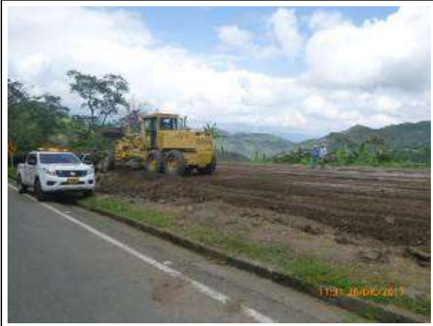
Explanación irregular Km 64+950
