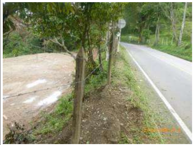
Explanación irregular Km 23+820
