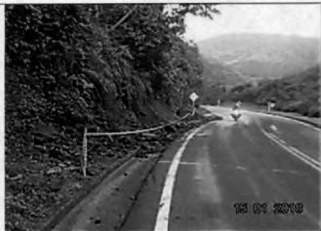
Foto 1. K58+150, Derrumbe, Margen Derecha
