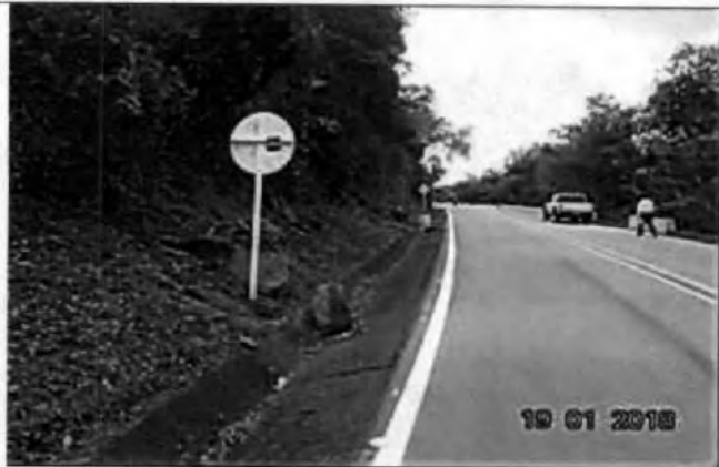
Foto 9. K6+640 al K6+920, falta limpieza de cuneta, costado izquierdo.
