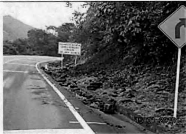
Foto 2. K58+220, Derrumbe, Margen Derecha
