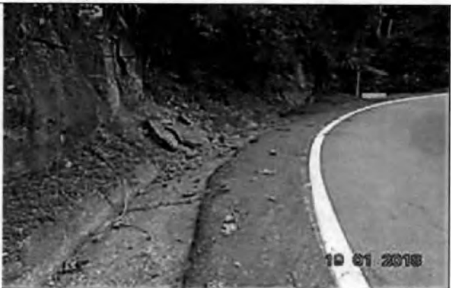
Foto 23. K12+110 al K12+200, limpieza de cuneta, costado izquierdo. Reparar bordillo.
