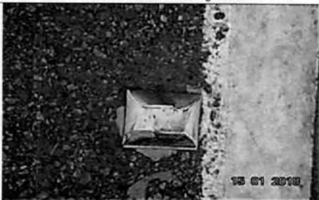
Foto 9. Tachas reflectivas en mal estado, Tramo Cambao – Chuguacal.
