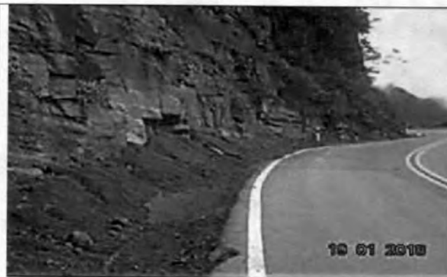
Foto 32. K27+800 al K27+850, falta limpieza de cuneta, costado izquierdo.
