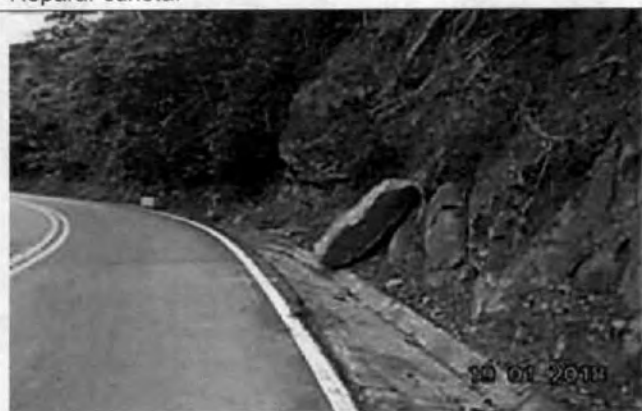
Foto 29. K16+580, falta retiro de rocas, costado derecho.
