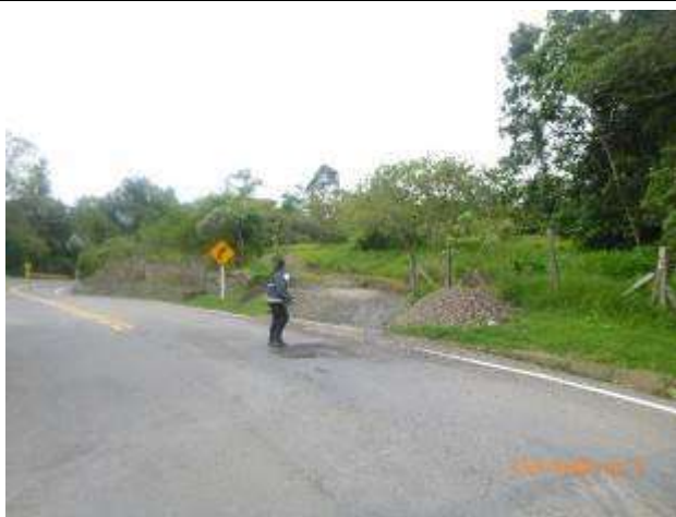
Acceso irregular Km 69+350
