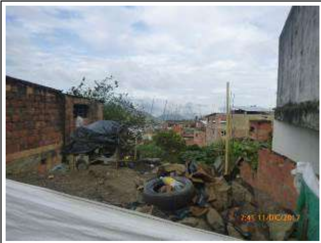
Construcción irregular Km 66+110
