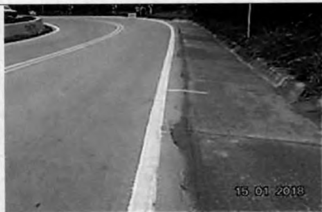
Foto 1. Borde de via sin tachas reflectivas, Tramo Villeta – Los Alpes.
