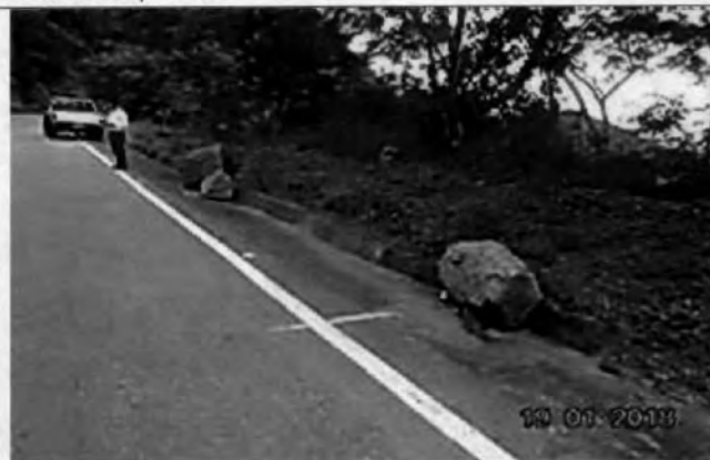
Foto 18. K10+380 al K10+390, falta limpieza de cuneta, costado derecho.
