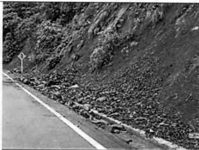
Foto 8. K59+530, Derrumbe, Margen Derecha
