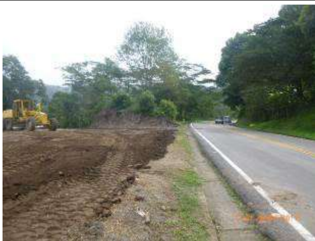
Explanación irregular Km 64+950
