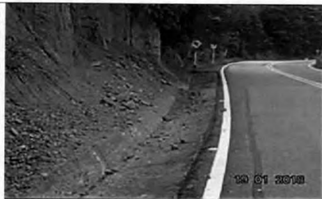
Foto 20. K11+510 al K11+530, falta limpieza de cuneta, costado izquierdo.
