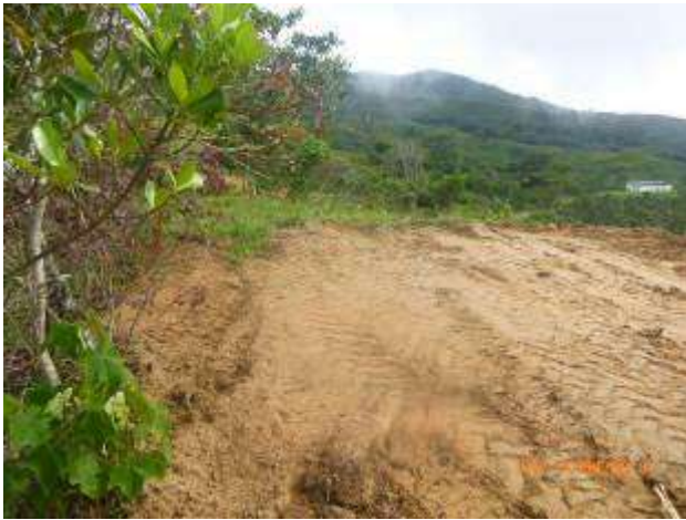
Explanación irregular Km 08+310
