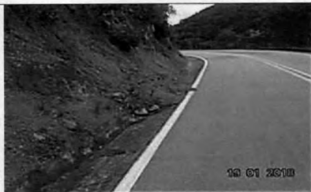
Foto 13. K8+180 al K8+280, falta limpieza de cuneta, costado izquierdo.
