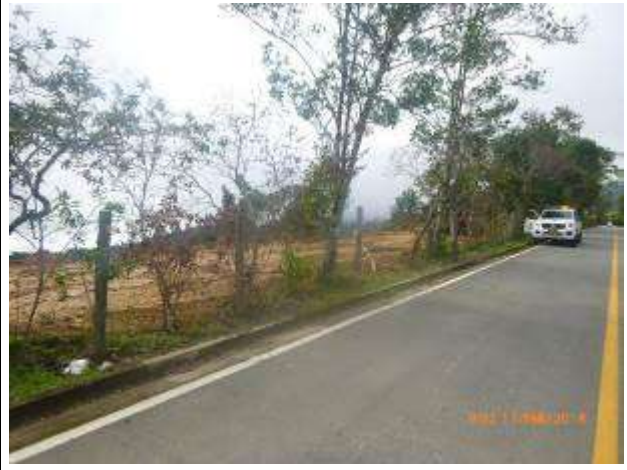
Explanación irregular Km 08+310
