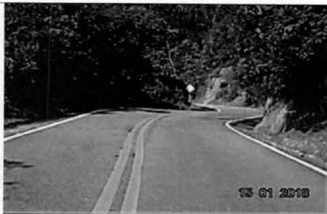
Foto 7. Línea central "eje" sin tachas reflectivas, Tramo Cambao – Chuguacal.
