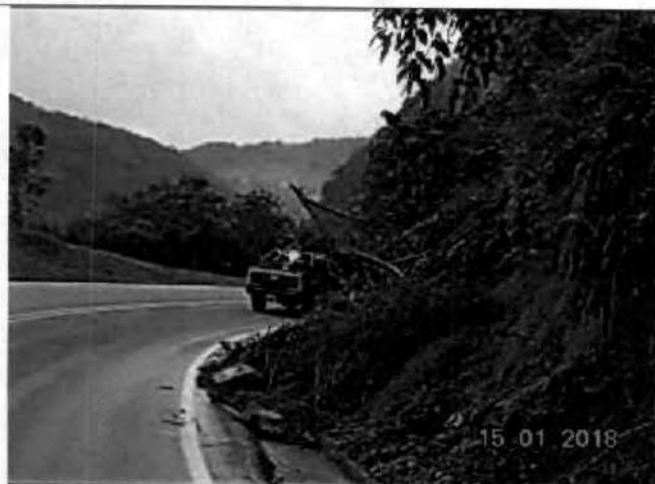
Foto7. K59+450, Derrumbe, Margen Derecha
