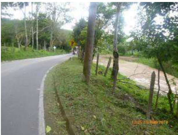
Explanación irregular Km 23+820
