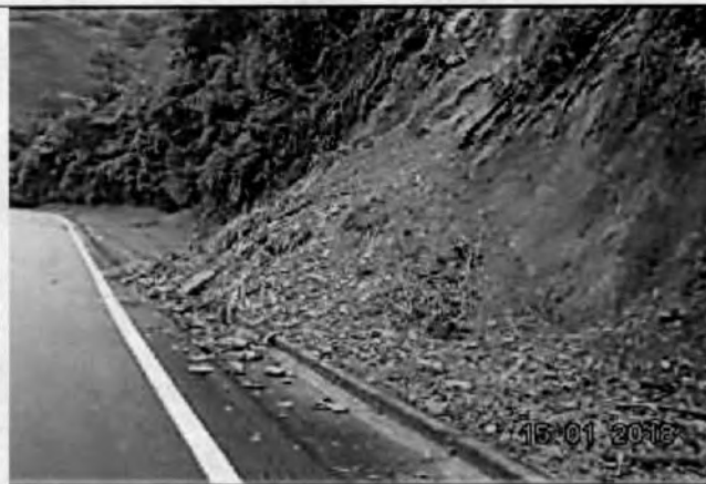
Foto 6. K59+300, Derrumbe, Margen Derecha
