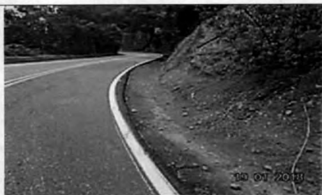
Foto 25. K12+520 al K12+580, falta limpieza de cuneta, costado izquierdo.
