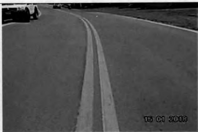
Foto 2. Línea central "eje" sin tachas reflectivas, Tramo Villeta – Los Alpes.
