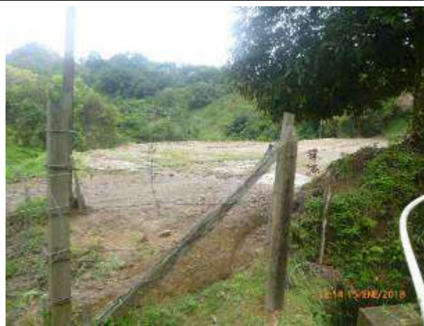
Explanación irregular Km 23+820
