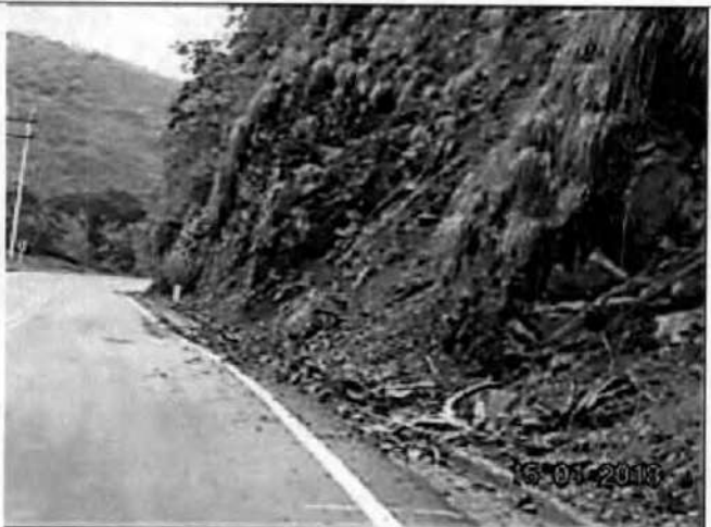
Foto 9. K59+950, Derrumbe, Margen Derecha
