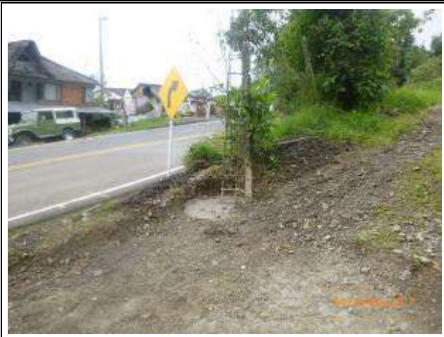
Acceso irregular Km 69+350
