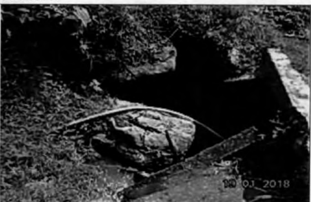
Foto 42. K69+300, falta retiro de roca.
