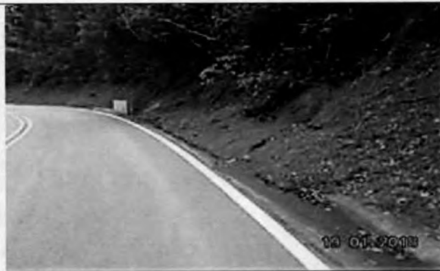
Foto 14. K8+340 al K8+360, falta limpieza de cuneta, costado izquierdo.
