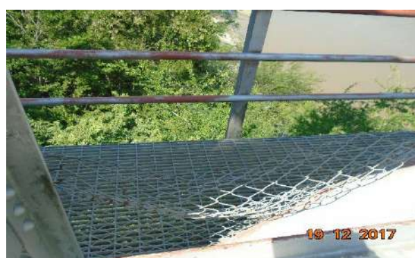
Estado actual de la malla antigua.
