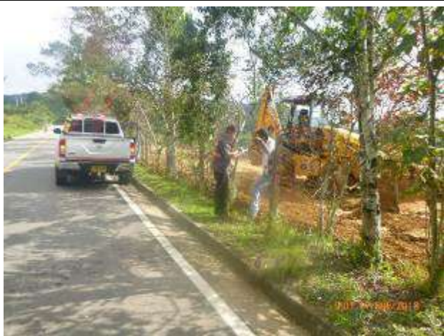
Explanación irregular Km 08+310
