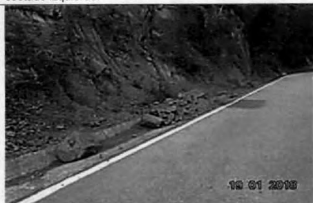
Foto 17. K10+330 al K10+410, falta limpieza de cuneta, costado izquierdo.
