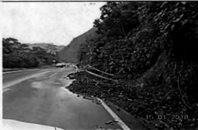
Foto 4. K59+010, Derrumbe, Margen Derecha
