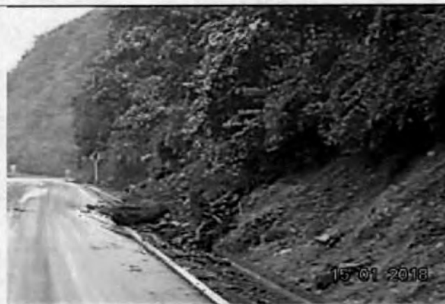
Foto 5. K59+100, Derrumbe, Margen Derecha
