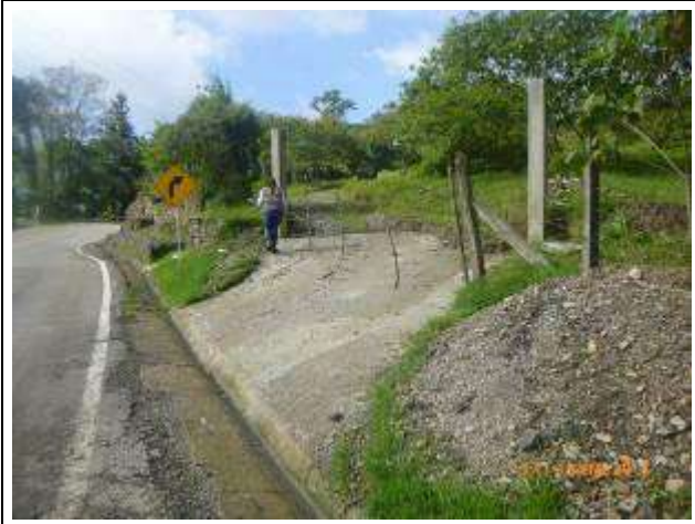
Acceso irregular Km 69+350
