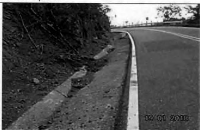
Foto 22. K11+750 al K12+000, falta limpieza de cuneta, costado izquierdo.
