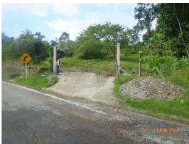
Acceso irregular Km 69+350
