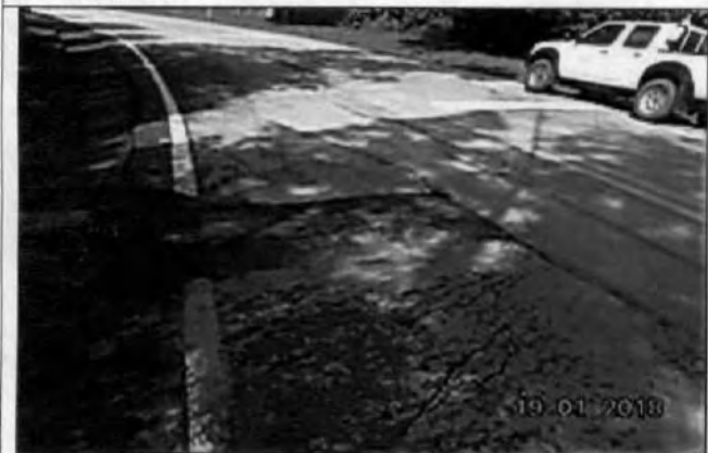
Foto 41. K69+300, falta reparación carpeta asfáltica.
