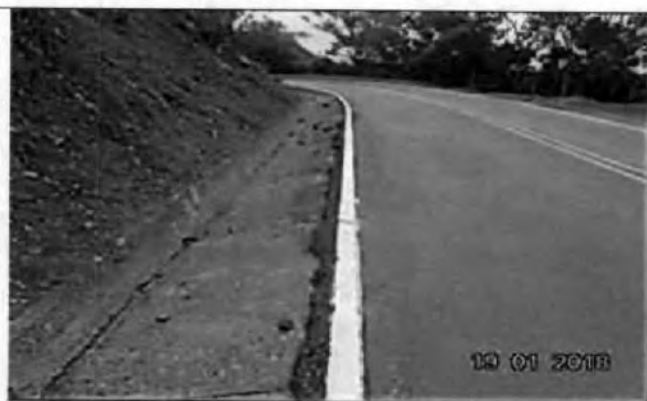
Foto 19. K10+600 al K10+630, limpieza de cuneta, costado izquierdo. Reparar bordillo.
