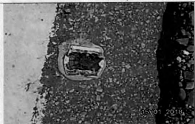
Foto 3. Tachas reflectivas en mal estado, Tramo Villeta – Los Alpes.
