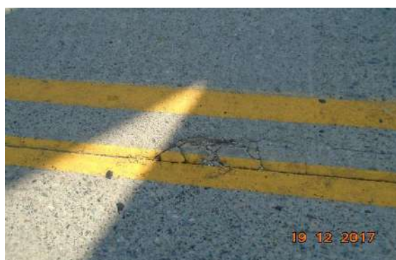
Segmento de losa no intervenido. Presenta fisuras
