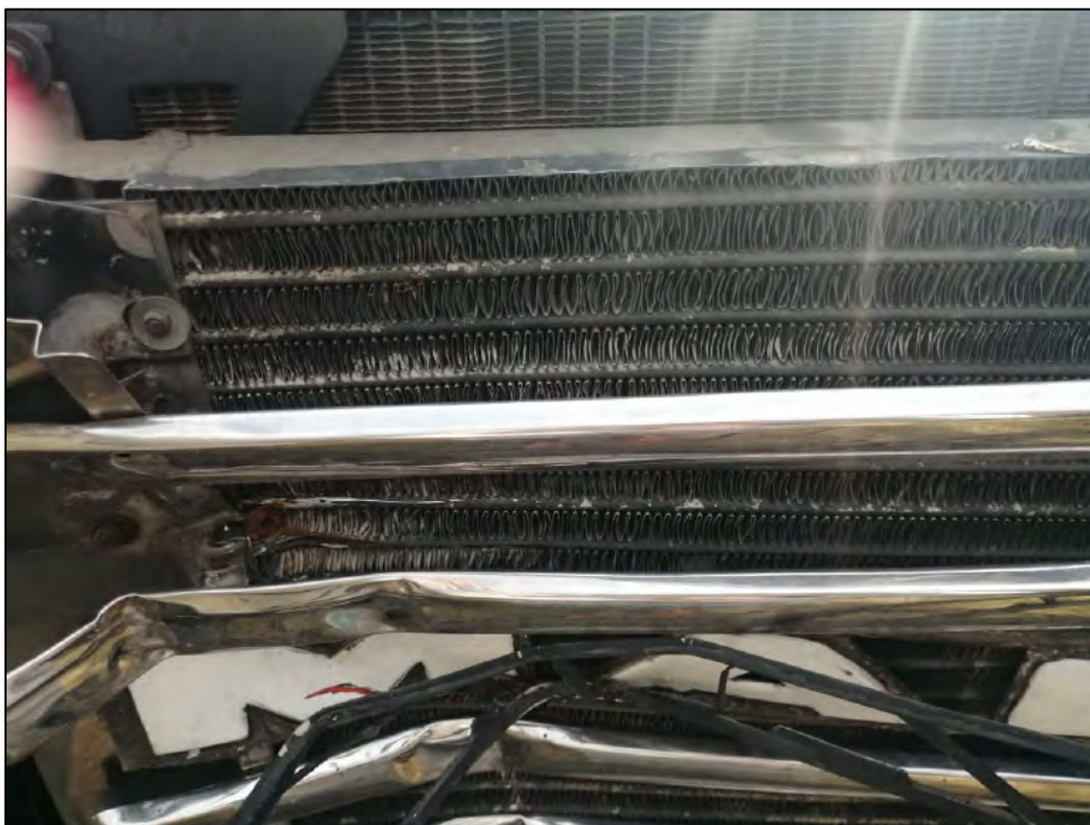
Foto 4 : Registro fotográfico suministrado por el Reclamante. Detalle daño en radiadores.
