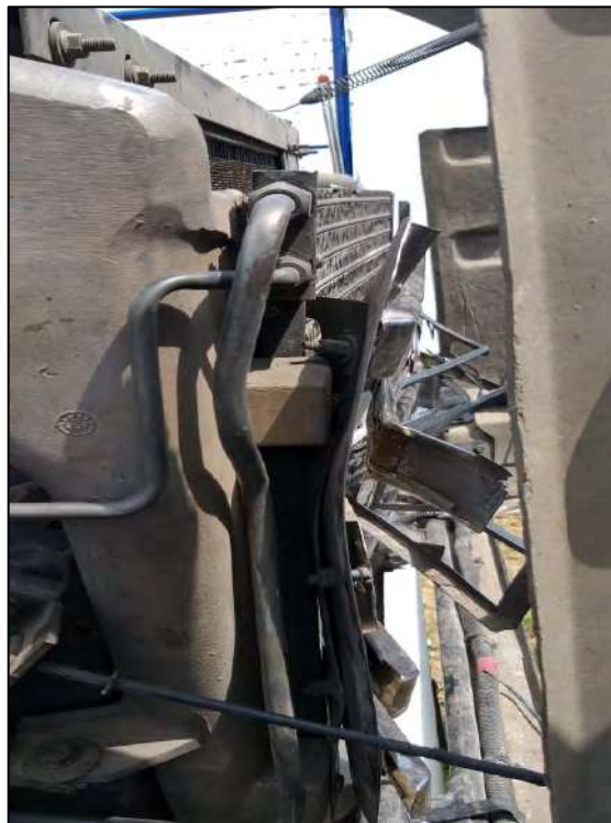
Foto 6 : Registro fotográfico suministrado por el Reclamante. Detalle daño en radiadores.
