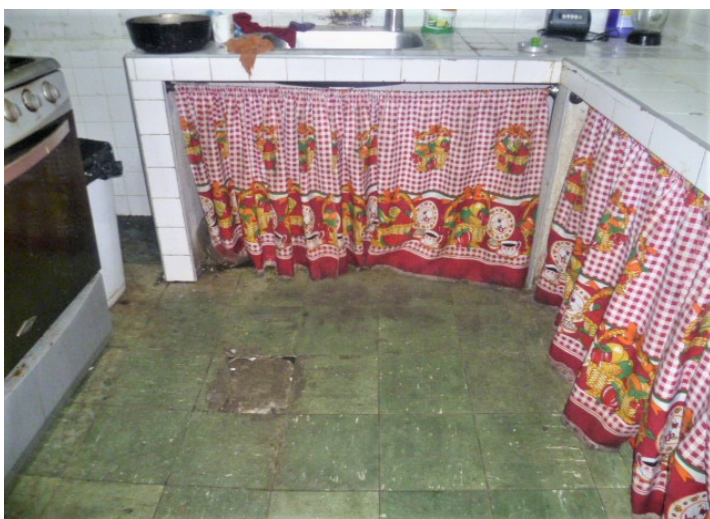
HUNDIMIENTO DEL PISO DE LA COCINA
