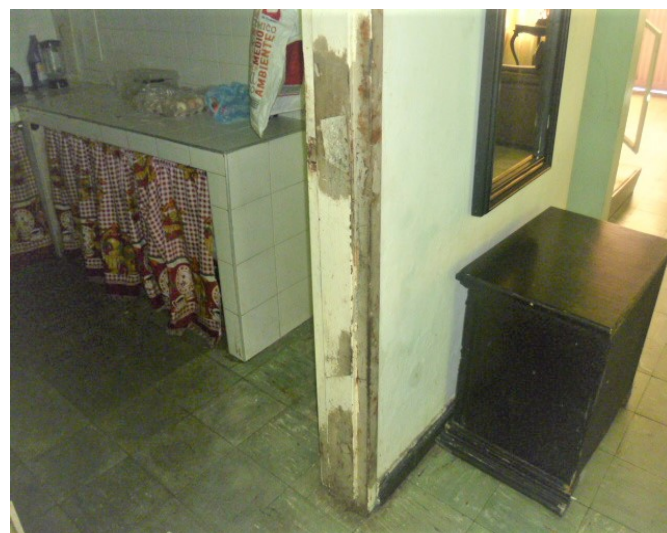
MAL ESTADO PINTURA
