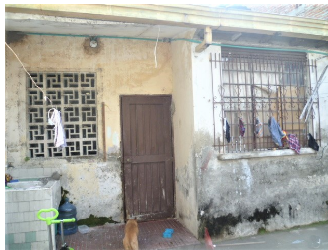
DETERIORO EN ACABADOS DE MUROS
