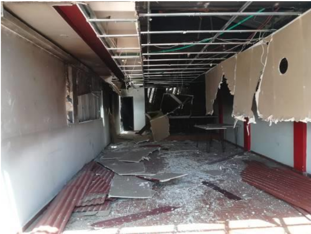
Estado de destrucción en la sala de eventos.
