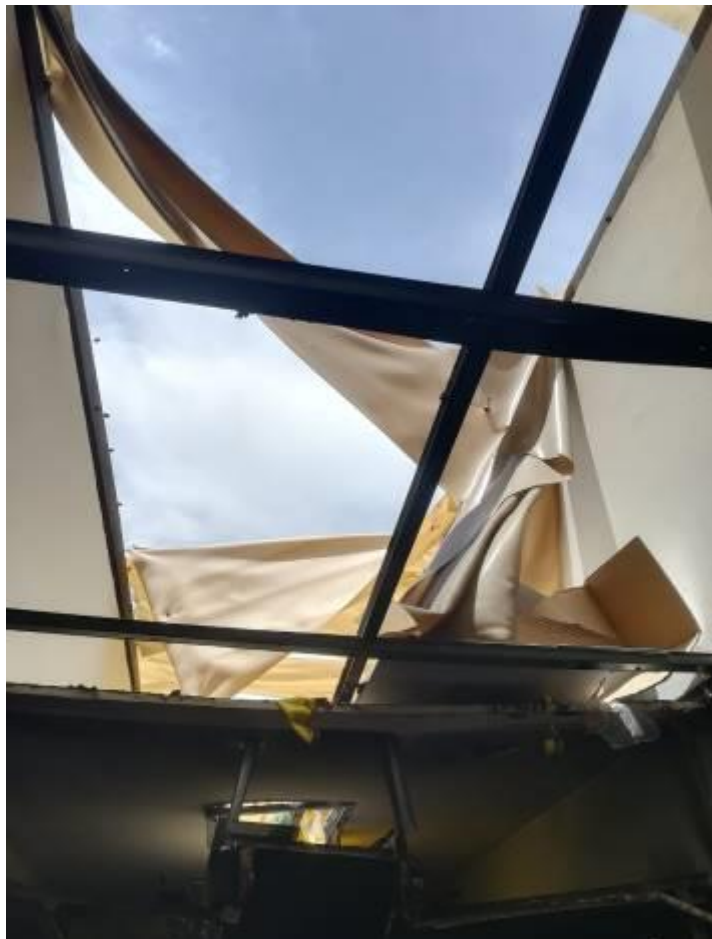
Estado de la cubierta en el fondo del restaurante.
