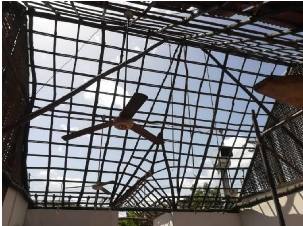
Estado incendiado de la cubierta del Kiosco.
