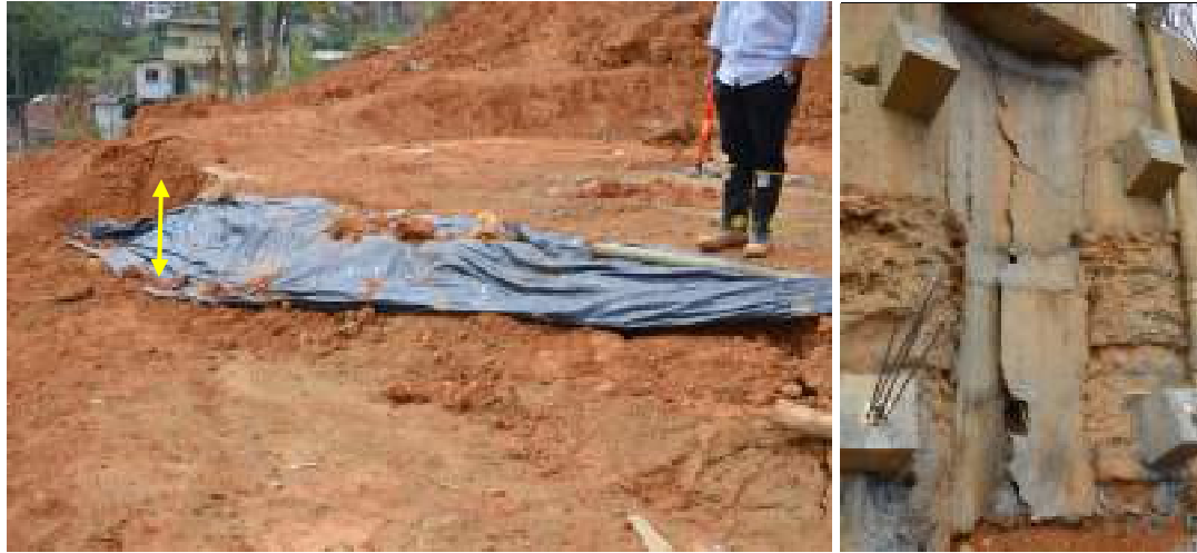
FIGURA 2. ESCARPE PRINCIPAL, FALLA POR EMPUJES EN LA PANTALLA ENTRE PILAS
