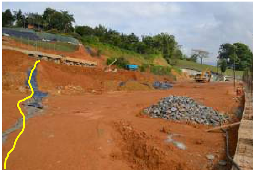
FIGURA 3. GRIETA ASOCIADA AL ESCARPE PRINCIPAL
