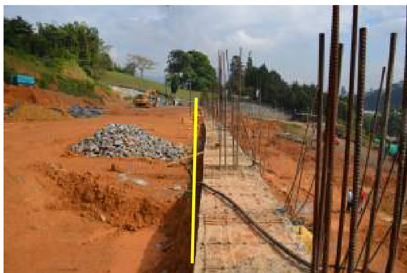
FIGURA 1. DEFORMACIONES EVIDENCIADAS A NIVEL DE LA VIGA CABEZAL
