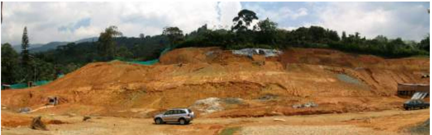
Foto 1 – Vista global de los cortes y la superficie de falla
