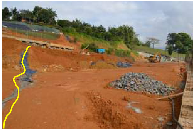
FIGURA 3. GRIETA ASOCIADA AL ESCARPE PRINCIPAL
