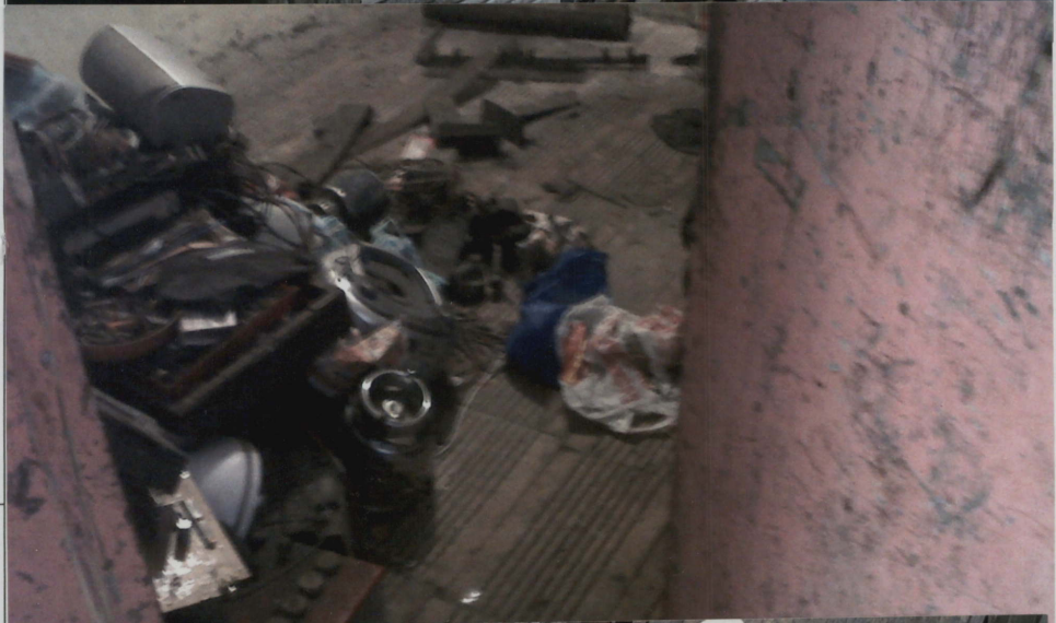
FOTO No 36 PATIO INTERNO USADO COMO DEPOSITO DE CHATARRA O DESECHO
