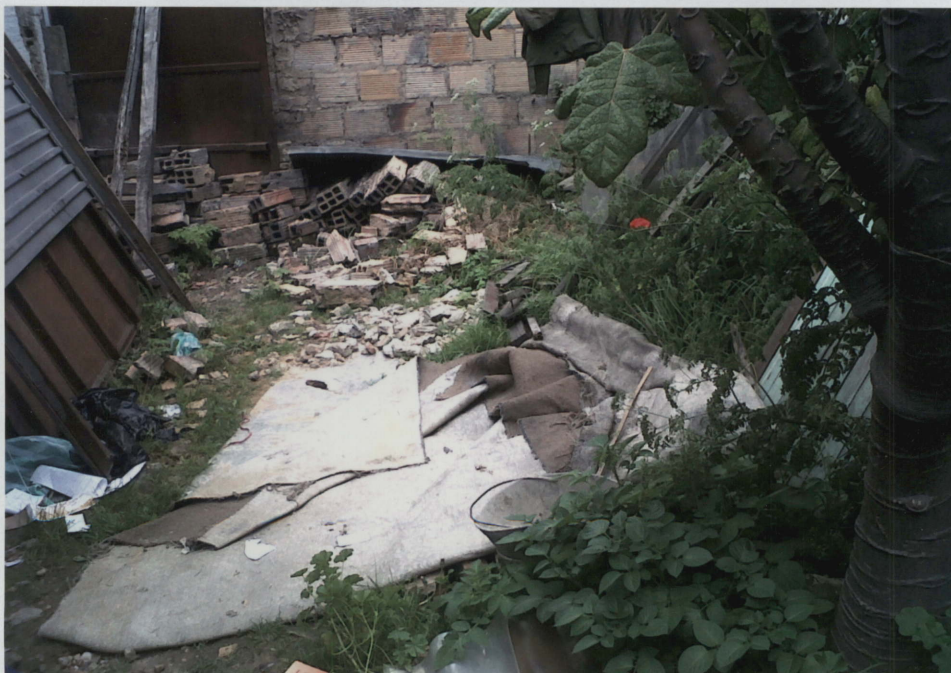
FOTO No 28 PATIO INTERNO CON ESCOMBROS Y MALEZA
