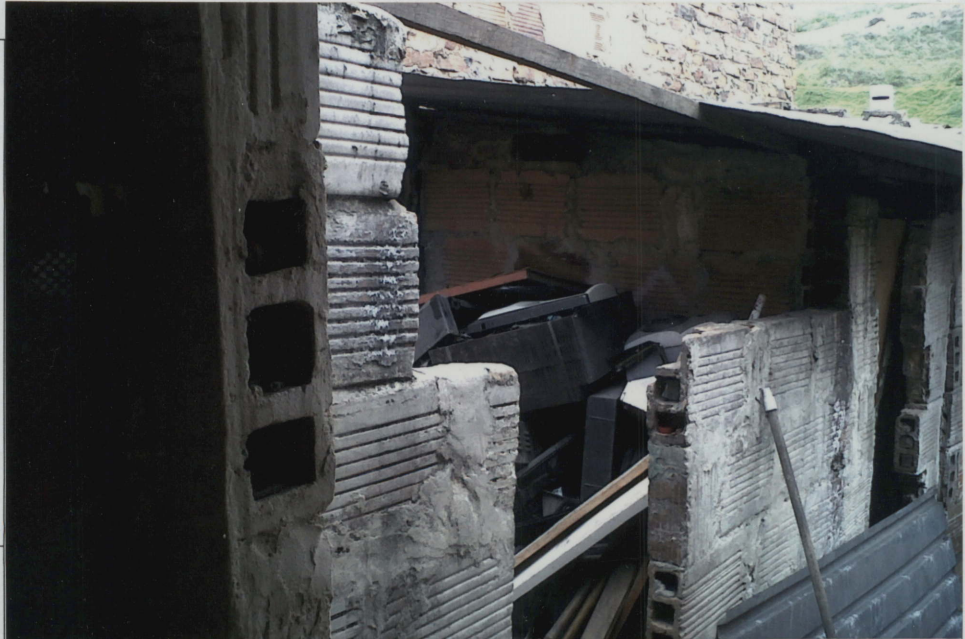
FOTO No 35 PATIO INTERNO USADO COMO DEPOSITO DE CHATARRA O DESECHO
