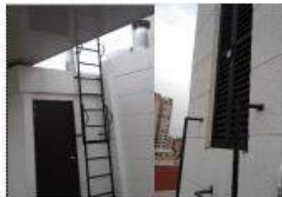
Foto 2. No cumple acceso a cuarto de máquinas resolución 1409 de trabajo en alturas y no existe inscripción de acceso prohibido en cuarto.
