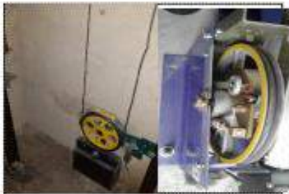
Foto 1. Cable de limitador con dobles y no se realiza prueba de limitador por ausencia de placa de especificaciones.
