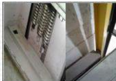
Foto 4. Falta pines en terminal de cables de cabina y no existe mecanismo de acoplamiento de pesas de contrapeso.
