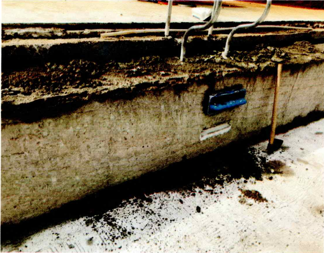
FILTRACIONES FONDO PISCINA
