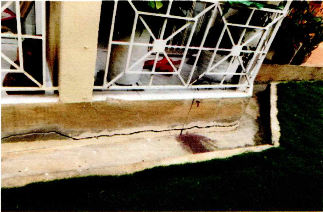
FILTRACIONES FONDO PISCINA
