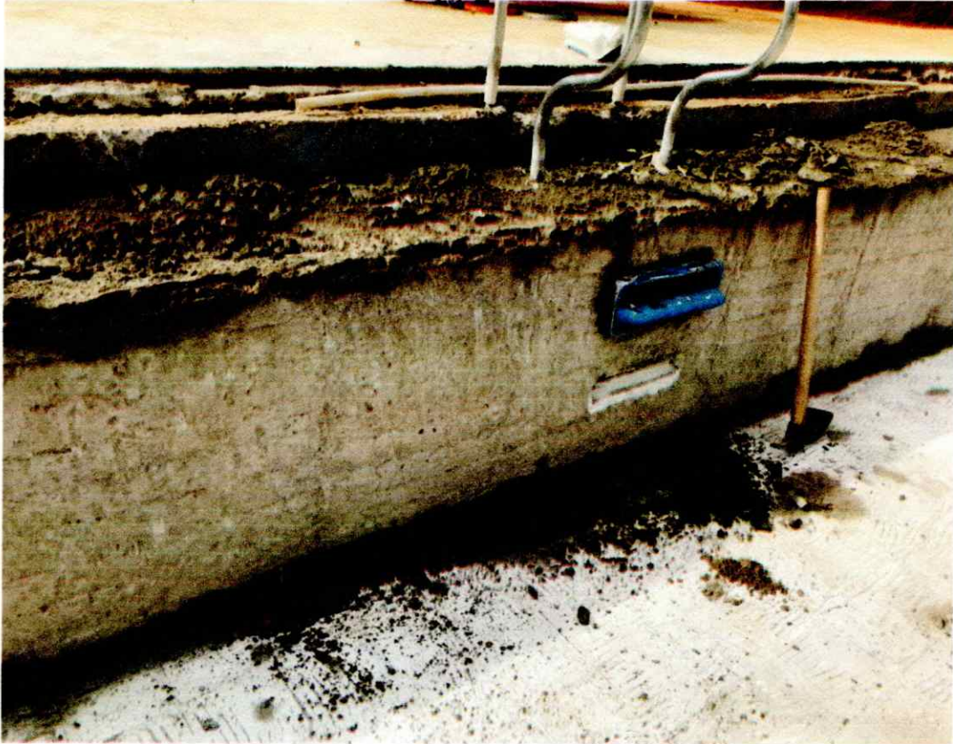
FILTRACIONES FONDO PISCINA
