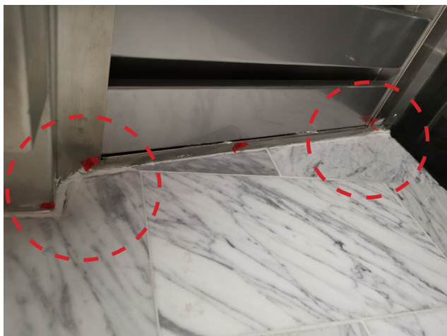
◀ Imágen 4E Filete entre la campana extractora y el enchape de pared
