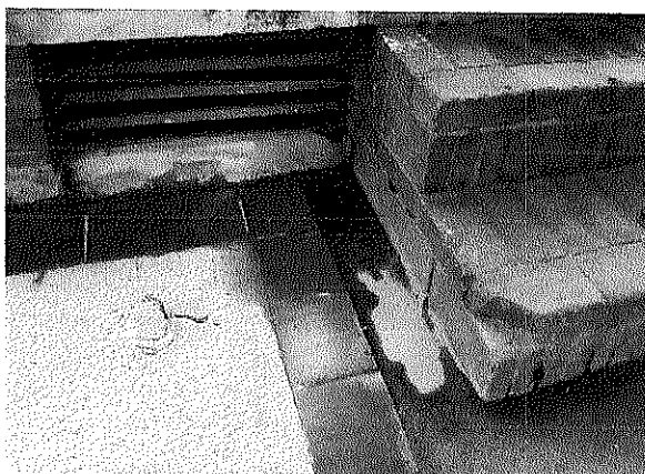
Muro limitante de escorrentía de agua, hace que rebose hacia la rejilla y caiga en los parqueaderos
