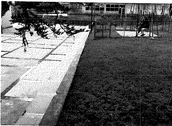
Muros de contención sin tratamiento de impermeabilización, no incluido dentro del contrato ni los adicionales, resume agua por las jardineras y zonas verdes
