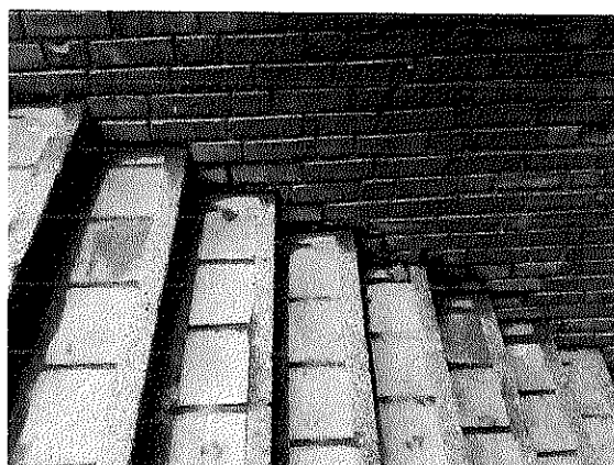
Humedades en las escaleras en unión contra el muro, zonas no tratadas en el contrato, produce humedades hacia parqueaderos
