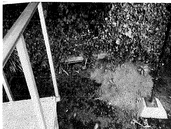
Zona verde con respiradero hacia parqueadero No 14, rebosa de agua y cae dentro de la zona vehicular
