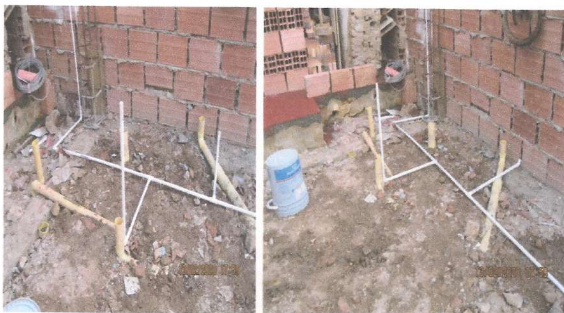
Instalaciones HidroSanitarias para baño y cocina.
