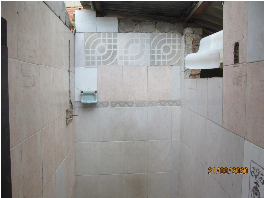
Baño enchapado con sobrantes de Obra.
