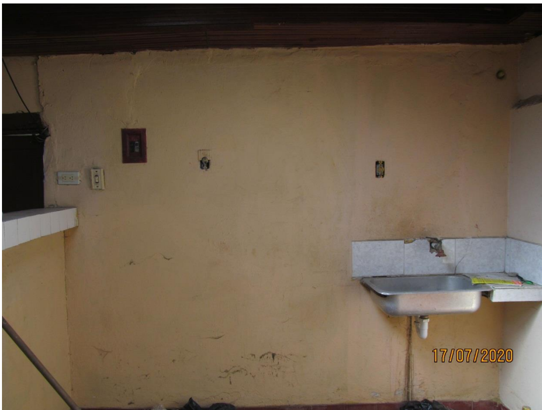
Lavaplatos sin grifería que se encontraba instalado en el inmueble.
