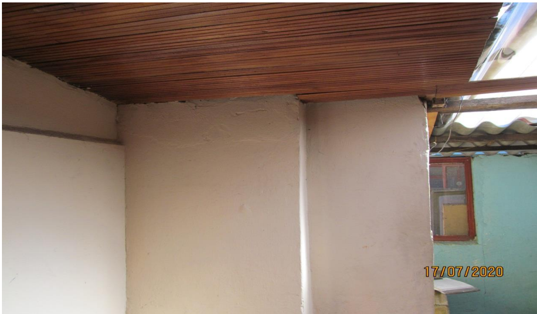
Estado inicial de los muros de la vivienda.
