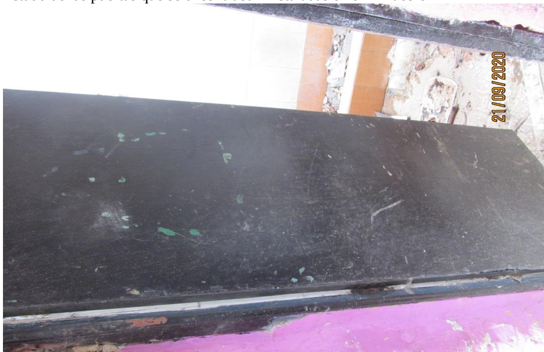
Estado de las puertas que se encontraban instaladas en el inmueble
