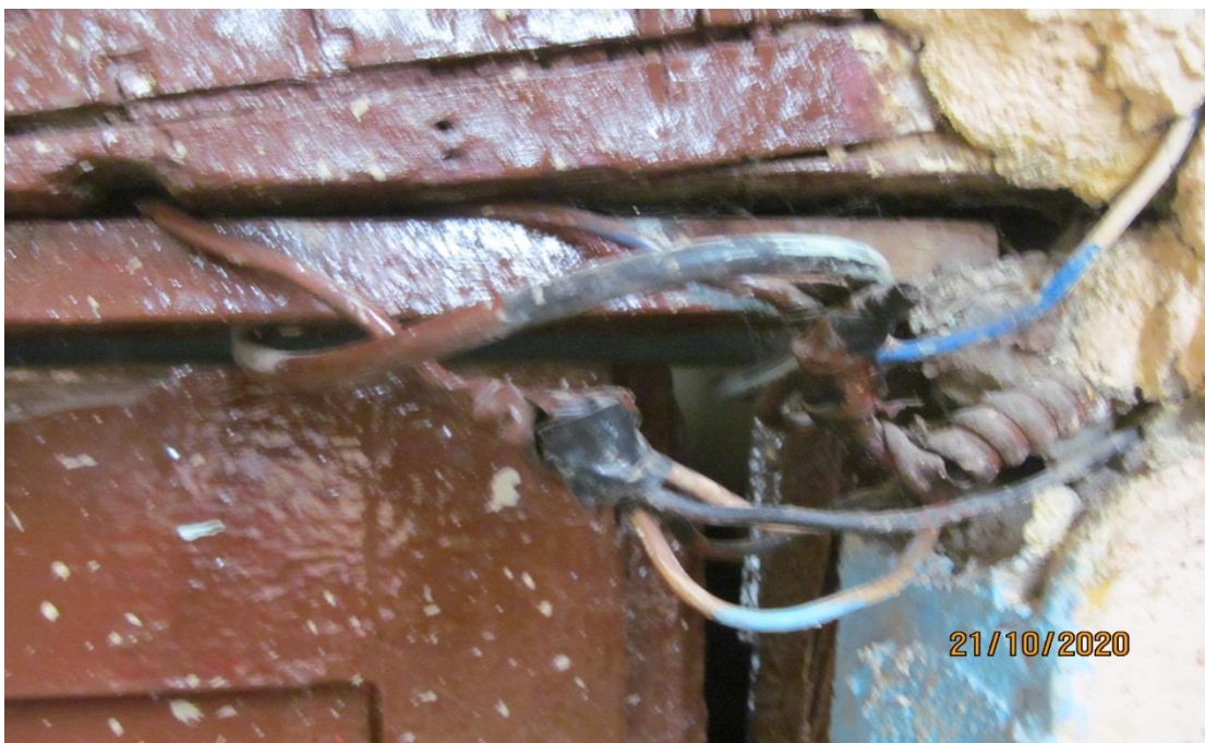
Estado de las conexiones eléctricas antes De.
