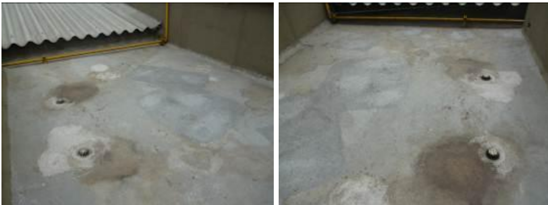
Placa plana sobre el costado oriental torre 1. Se puede observar que han sido continuas las fallas de la impermeabilización por punzonamiento en las aristas o rompimiento en las hendiduras. No obstante, los arreglos no incluyen el mejoramiento del afinado de la superficie por lo tanto se espera que estos problemas se sigan presentando.
