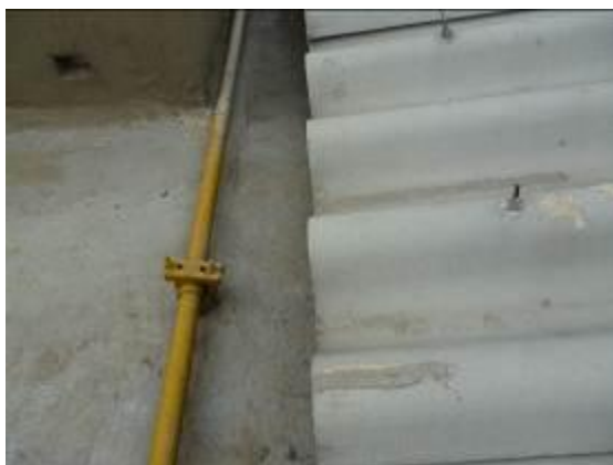
Tejas fisuradas y rotas frente al vacío del costado oriente torre 1.
