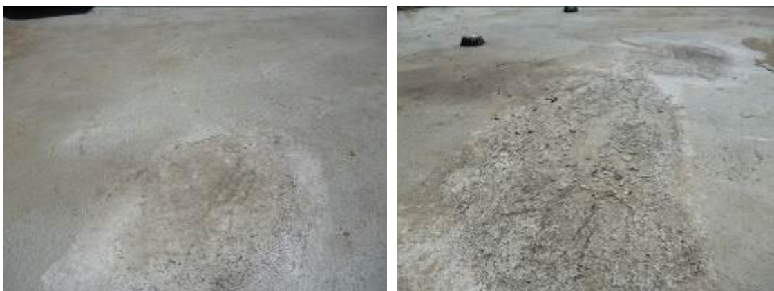
Loza plana adyacente al vacío occidente de la torre . Detalle de mala aplicación del material de la impermeabilización.
