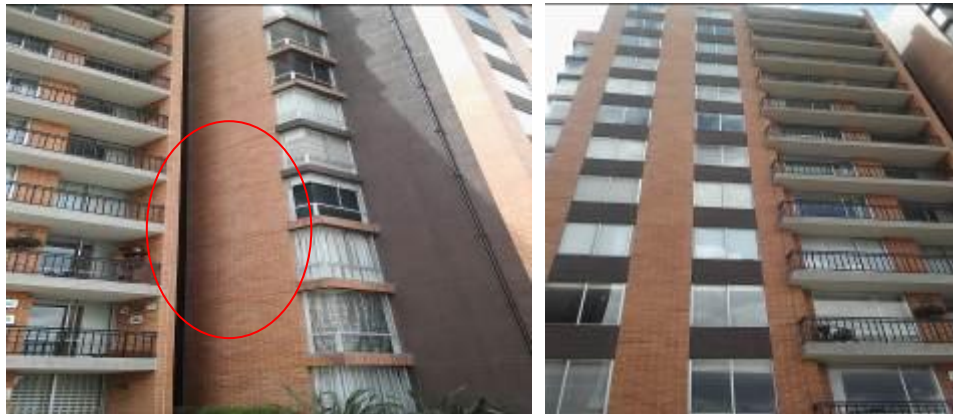
Afectación del ladrillo de fachada posterior torre 3 por meteorización acelerada, media y lenta por ácido remanente.
