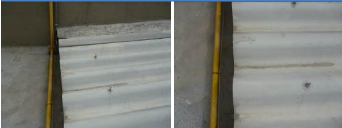
Costado sur torre 1. Tejas rotas y tejas que han sido objeto de reparaciones.
