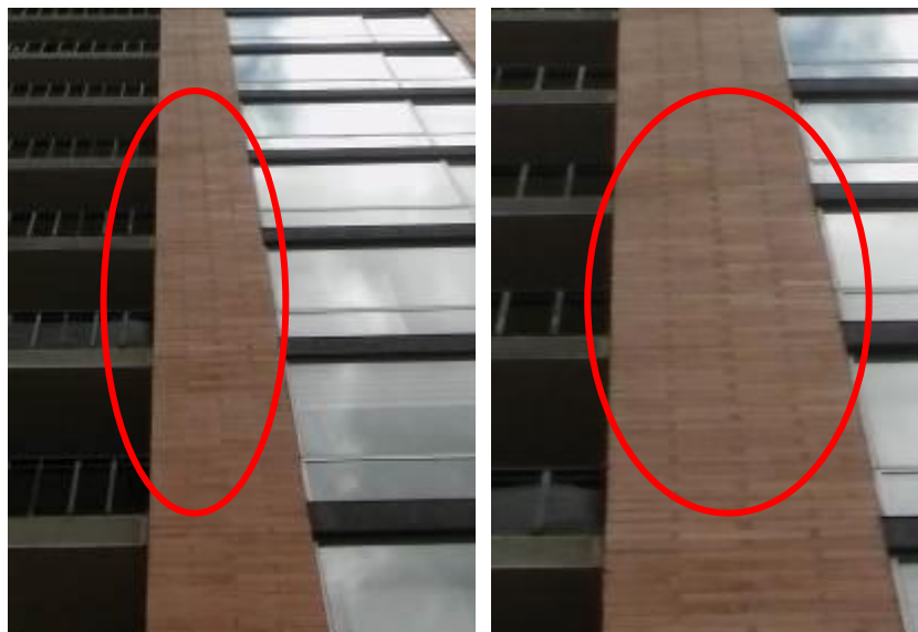
Ladrillo fachada occidental torre 1 piso 5 a piso 12 deterioro por meteorización acelerada
