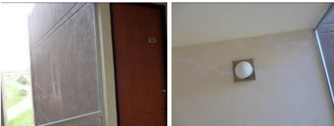
Afectación por humedad causada por filtración de agua al interior de la torre 3 junto apartamento 1203
