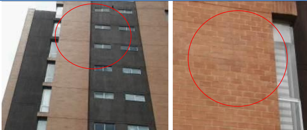
Meteorización acelerada en el ladrillo de la fachada posterior y lateral torre 3
