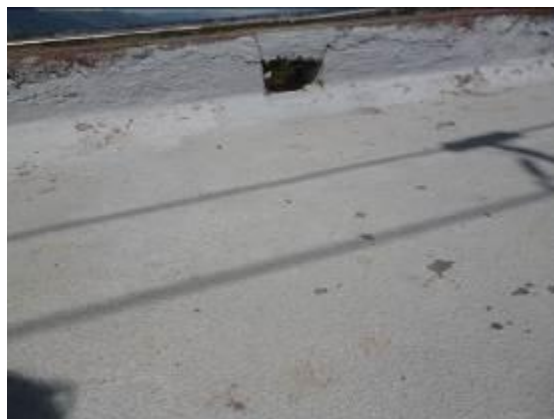
Cubierta cuarto de máquinas. Desagüe en el costado norte muy alto comparado con el nivel de la placa. Situación que permite empozamientos de agua y deterioro acelerado de la impermeabilización.
