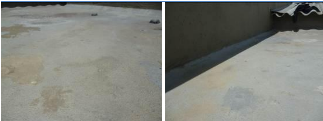
Costado occidental torre 2. El material fue aplicado sobre una superficie no apta por hendiduras y rugosidades que presenta.
