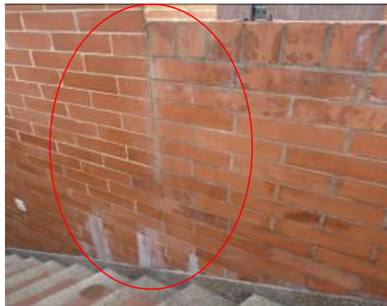
Afectación en el ladrillo por humedad
