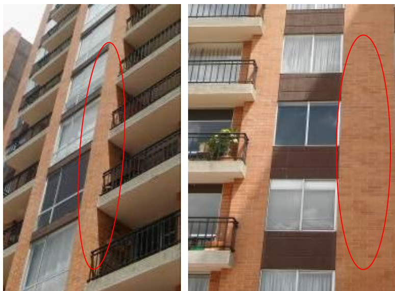
Meteorización acelerada y delaminación del ladrillo en la fachada principal de la torre 2.
