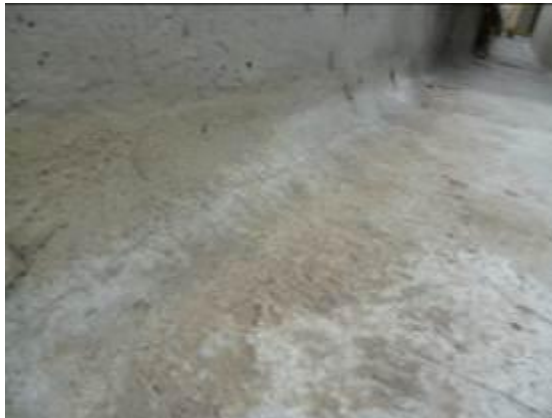
Media caña ubicada al costado norte torre 1 presenta rugosidades en la superficie donde se aplicó la impermeabilización, situación no permitida en las fichas técnicas del material utilizado.
