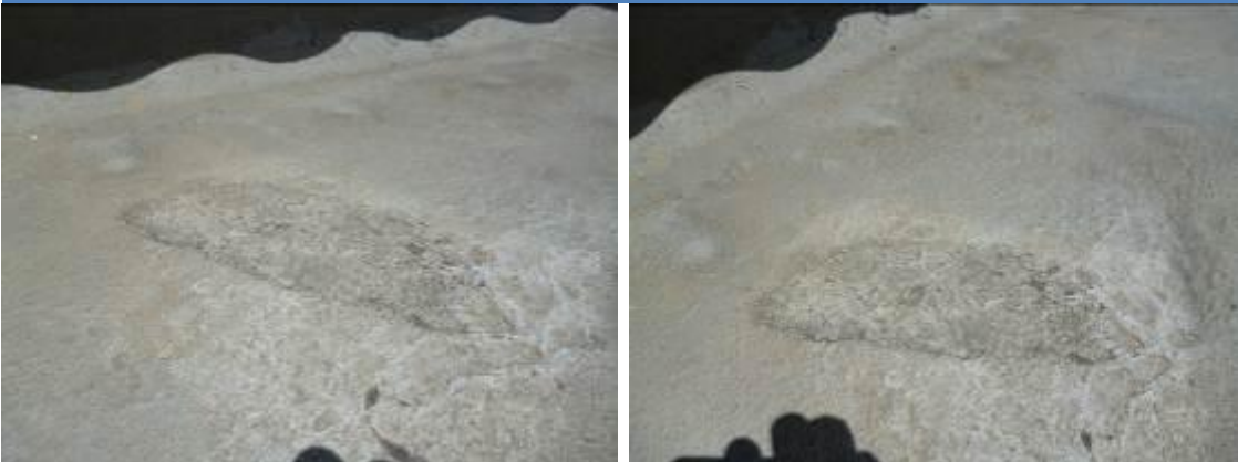
Loza plana adyacente al vacío occidente. La reparación de la impermeabilización se realizó sin reparar el afinado de la superficie por lo cual se espera que en el corto plazo falle nuevamente.
