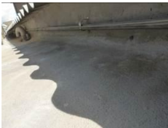
Media caña por el costado sur torre 2. También estas media cañas tienen acabados muy deficientes por la alta rugosidad. Adicionalmente se observa que la impermeabilización no alcanza a cubrir la media caña y menos el muro.
