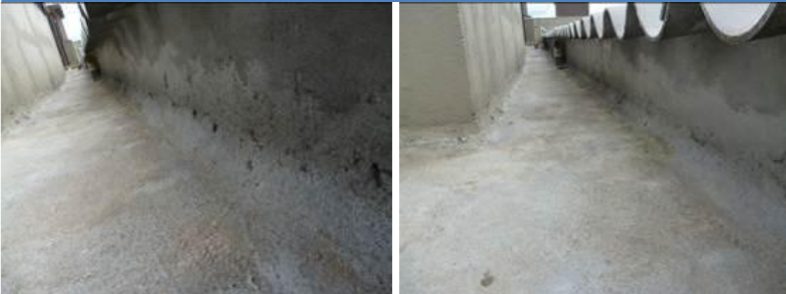
Torre 1 costado sur. Acabado deficiente del mortero de la media caña que genera aristas y hendiduras en la impermeabilización con el consecuente rompimiento de la misma.
