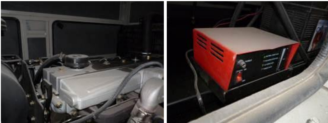
Polvo en el interior de la planta de generación eléctrica.
