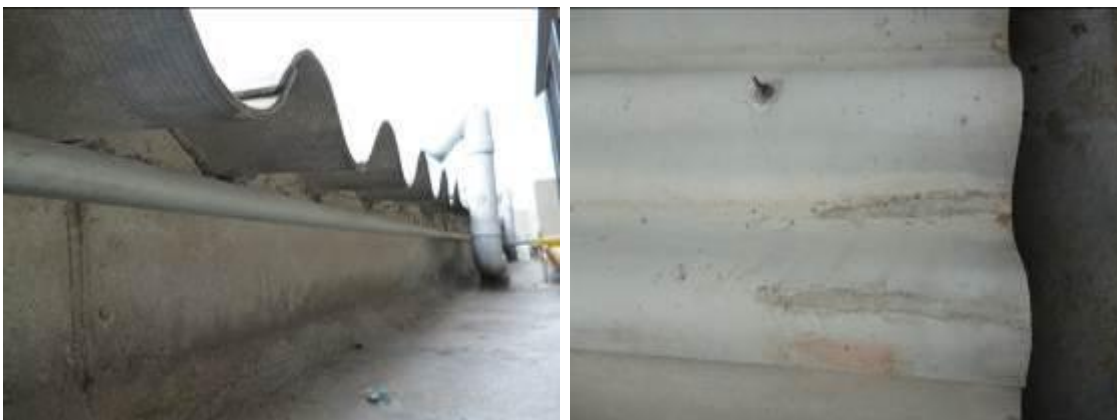
Teja rota frente a los medidores del gas por el costado sur. El apoyo en la cubierta deja de ser homogéneo frente al vacío.
