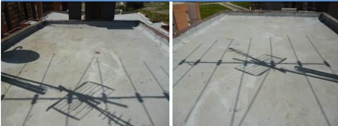
Vista general de la placa de cubierta de cuarto de máquinas. La situación es la misma de las demás cubiertas por deficiencias de afinado de la losa y reparaciones que se han ejecutado.
