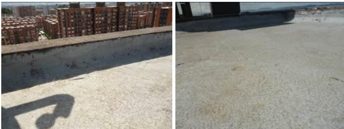
Cubierta cuarto de máquinas Acercamientos para mostrar el mal estado por hendiduras, pliegues y rugosidades.
