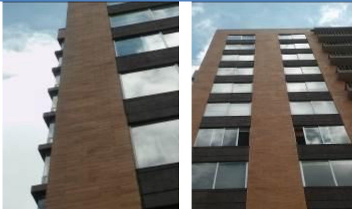
Tramo de ladrillo ubicado al costado occidental torre 1 fachada principal, con deterioro acelerado por meteorización acelerada.
