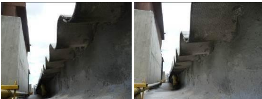
Los desniveles en apoyo de las tejas causa su rompimiento en las cubiertas de fibrocemento torre 1.
