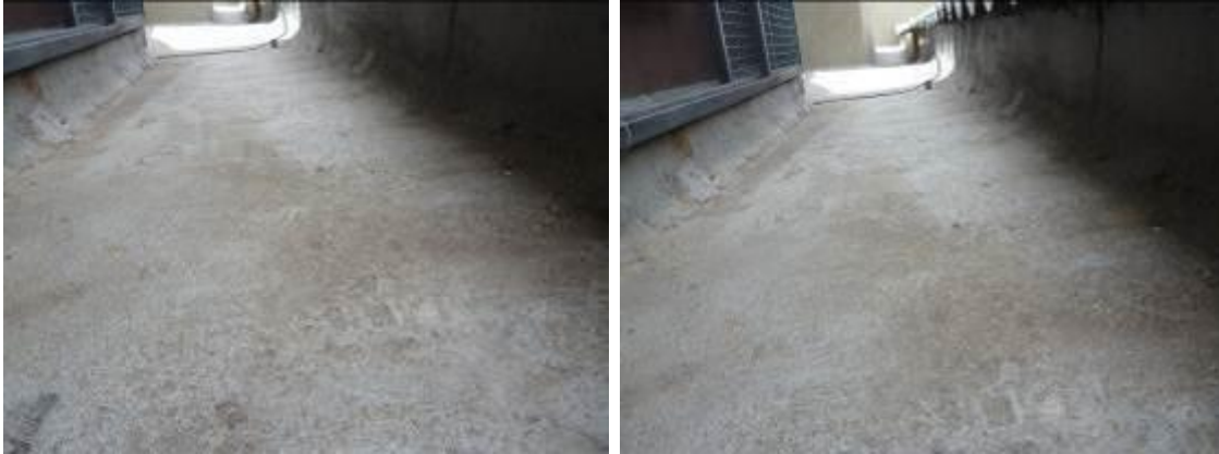
Frente a los medidores de gas por el costado sur torre 1. Alta rugosidad de la superficie de la losa.
