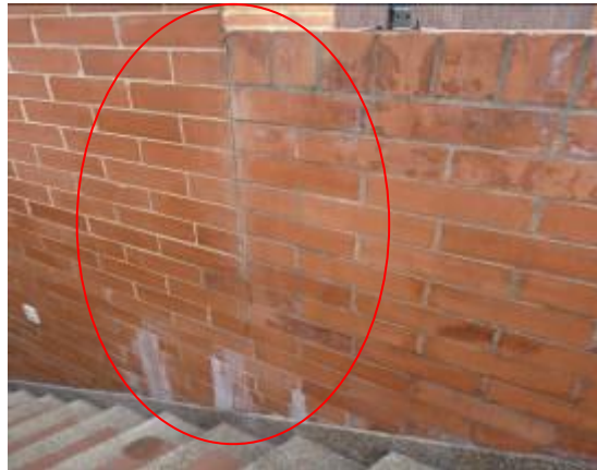
Afectación en el ladrillo por humedad
