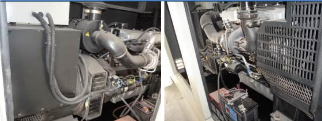
Interior de planta eléctrica con mucho polvo
