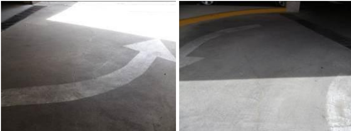
Fisuras existentes frente a la rampa de acceso y salida del sótano
