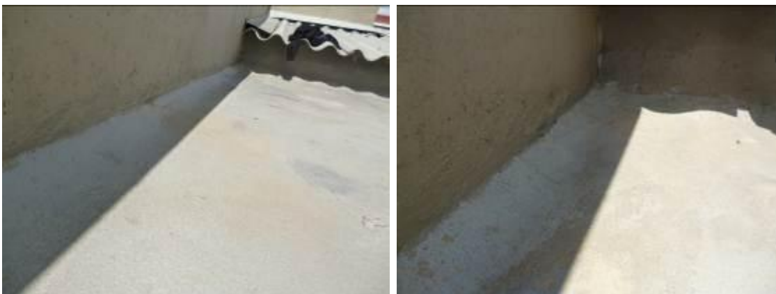
Media caña por el costado occidente torre 2 con presencia de hendiduras y restos de mortero sobre el cual se instaló la impermeabilización.
