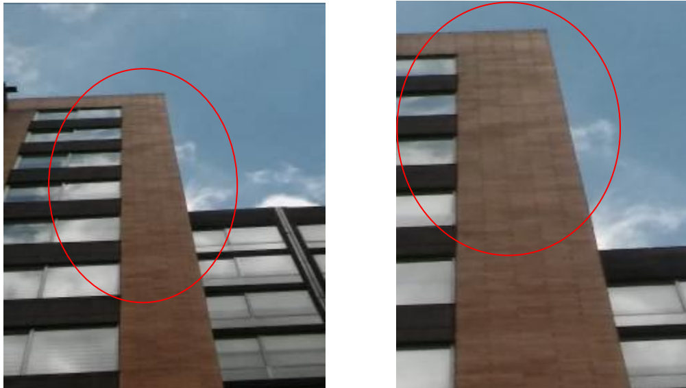
Fachada en ladrillo ubicada al costado oriental de la fachada principal torre 1. Meteorización acelerada y media.
