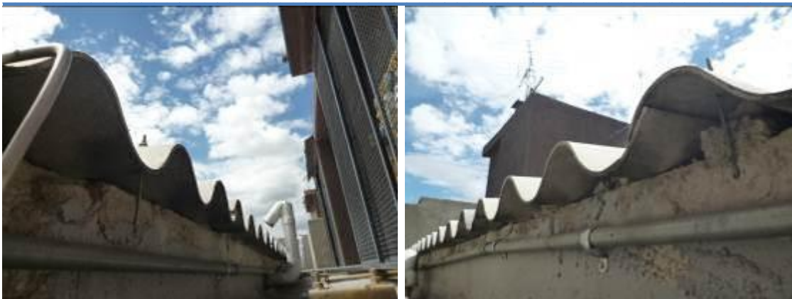
Tramo entre el vacío de oriente y la puerta de acceso a los medidores de gas del costado sur torre 1. El apoyo de la teja no es continuo y el sellamiento de los roblones no es el adecuado.
