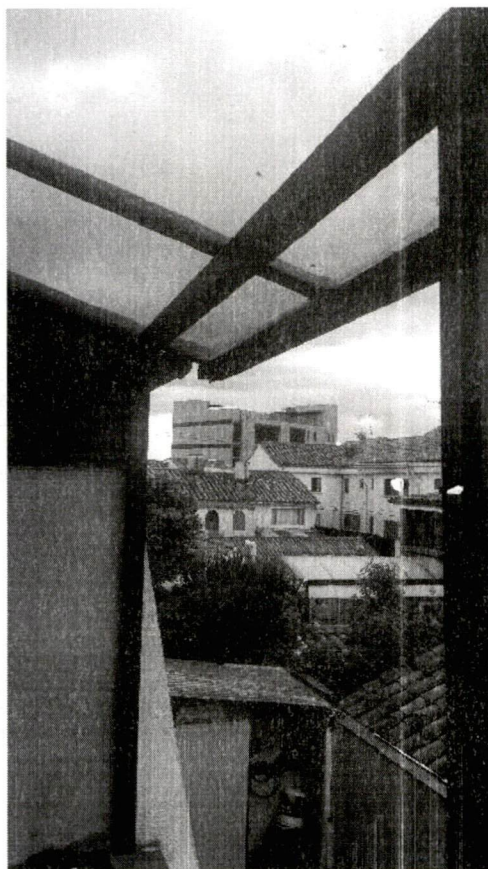
FOTO No 3 Canal de Remate de Marquesina Apto 203 con sección insuficiente
