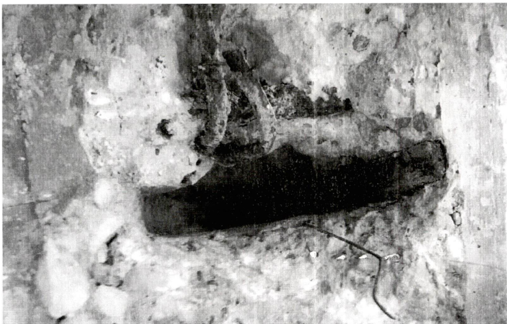
FOTO No 5 Agujero parte inferior placa de entepiso al interior del apartamento 102
