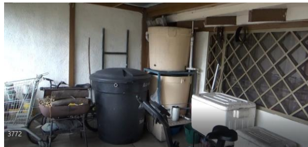
Tanque de agua que generan peso sobre edificio no contemplado para ese uso.
