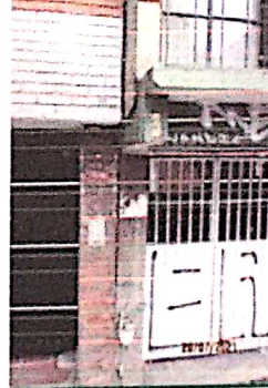
DESPRENDIMIENTO LINDERO NORTE
