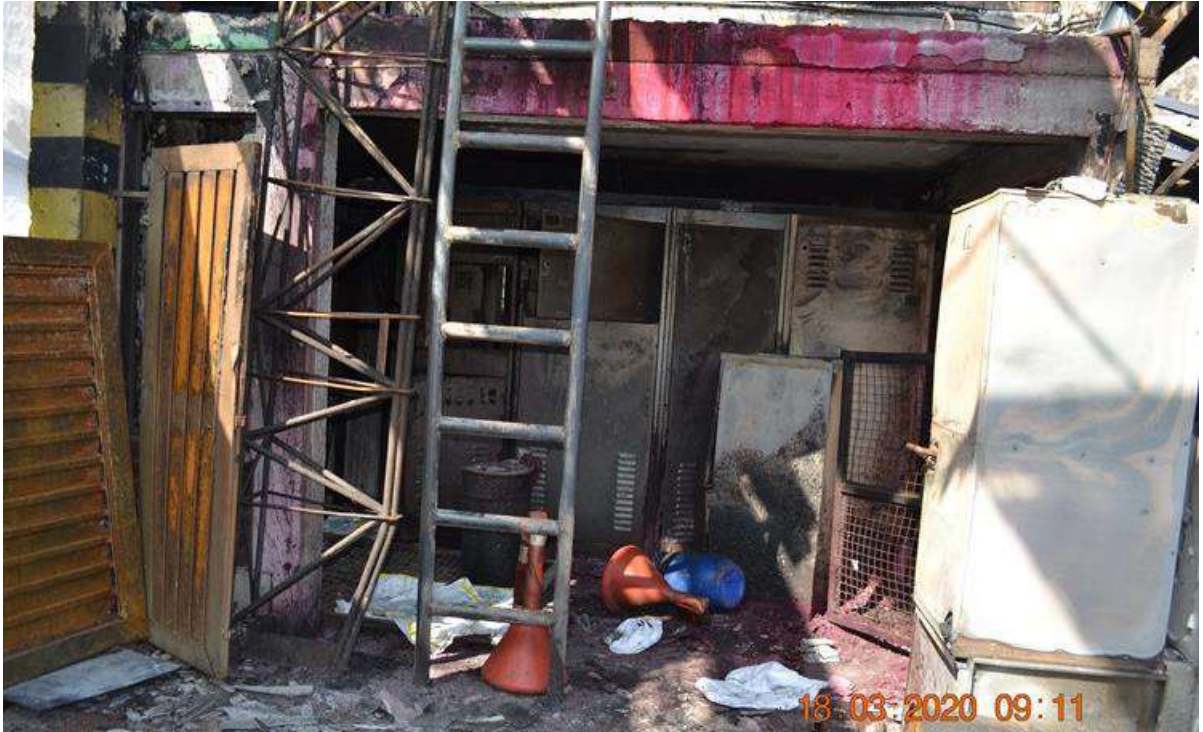
Se nota la ubicación del cuarto de la subestación eléctrica.
