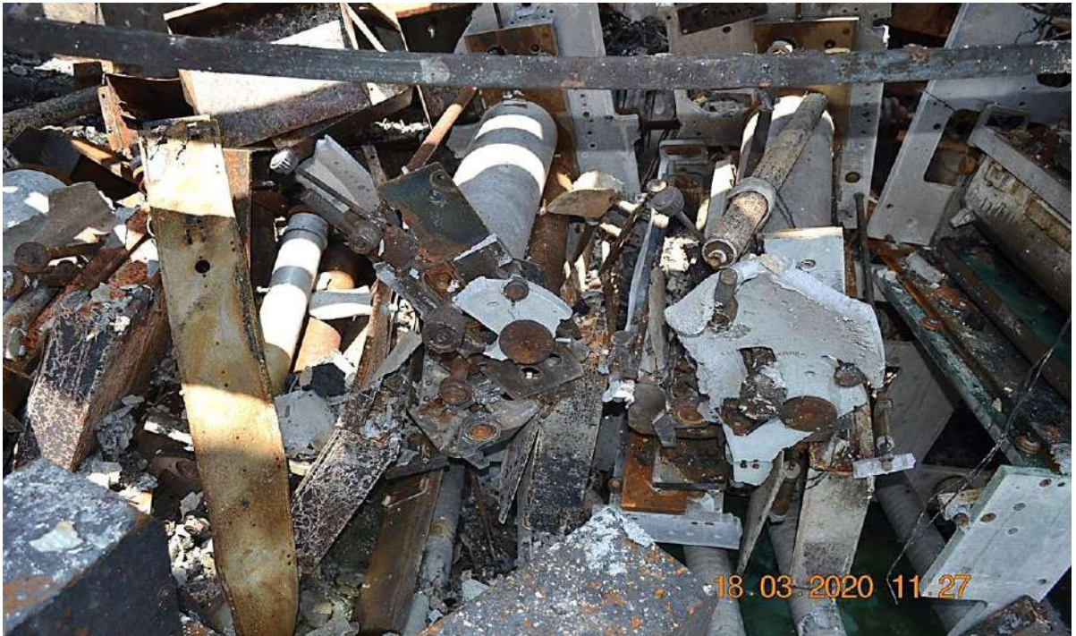
Se aprecia el costado izquierdo del área de origen del incendio.
