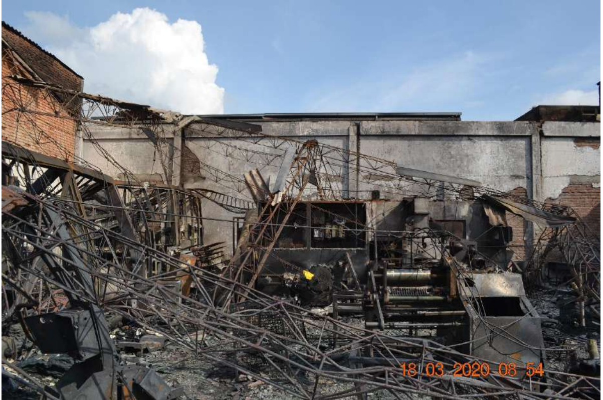
Se aprecia el estado de la máquina engomadora.
