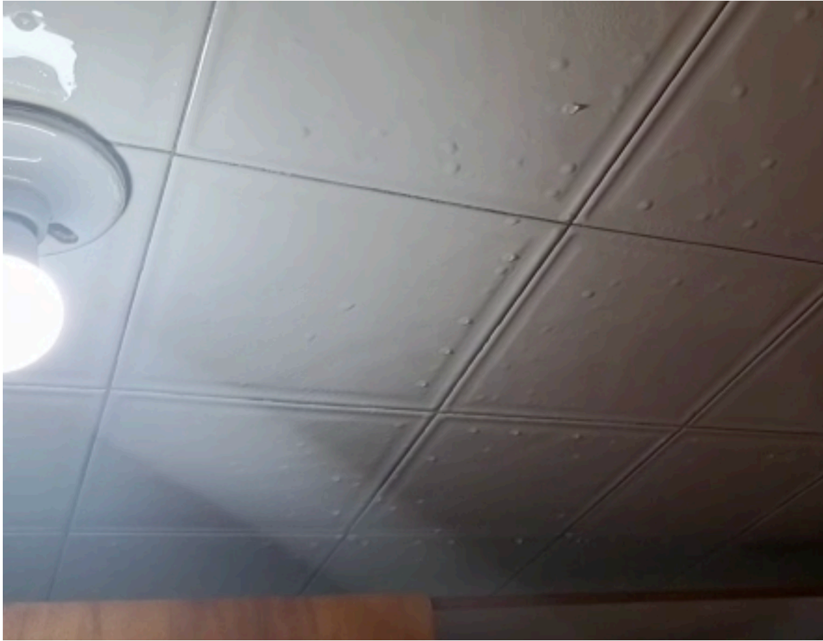
Filtraciones y humedades en el techo de la cocina
