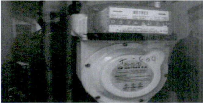
Contador de Gas
