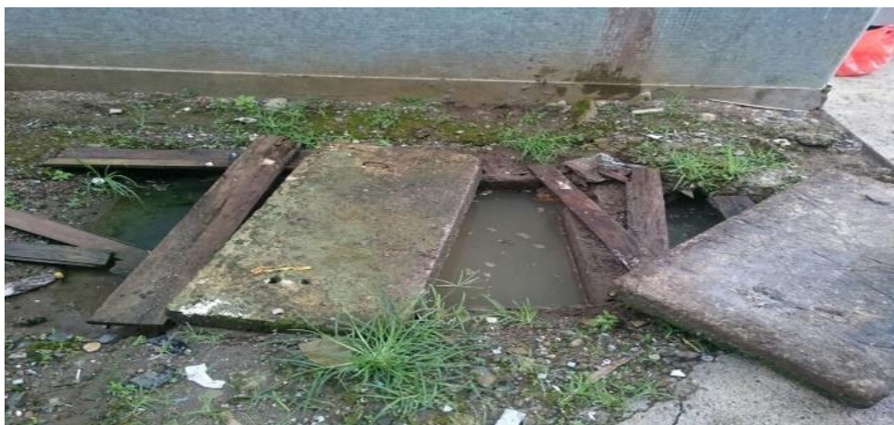
Aguas empozadas en la ESE
