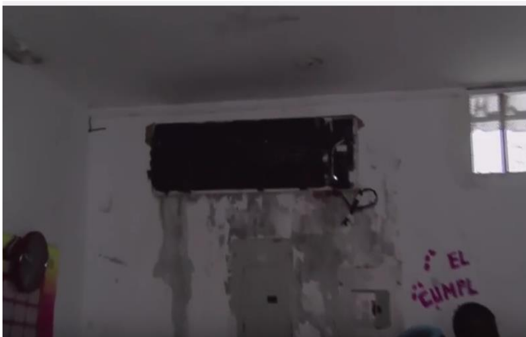
Aire acondicionado del pabellón de psiquiatría
