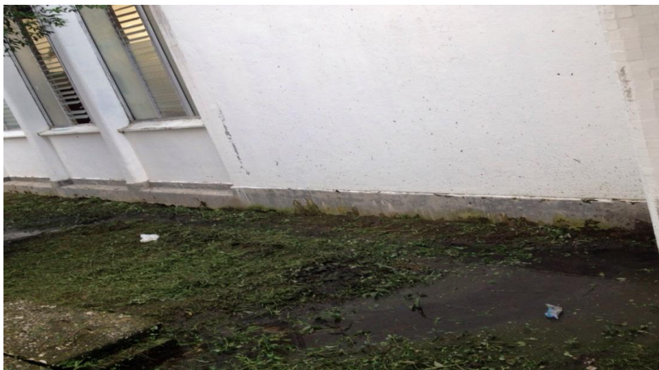
Aguas estancadas al interior del Hospital
