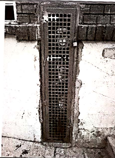
MEDIDORES DE GAS NATURAL
