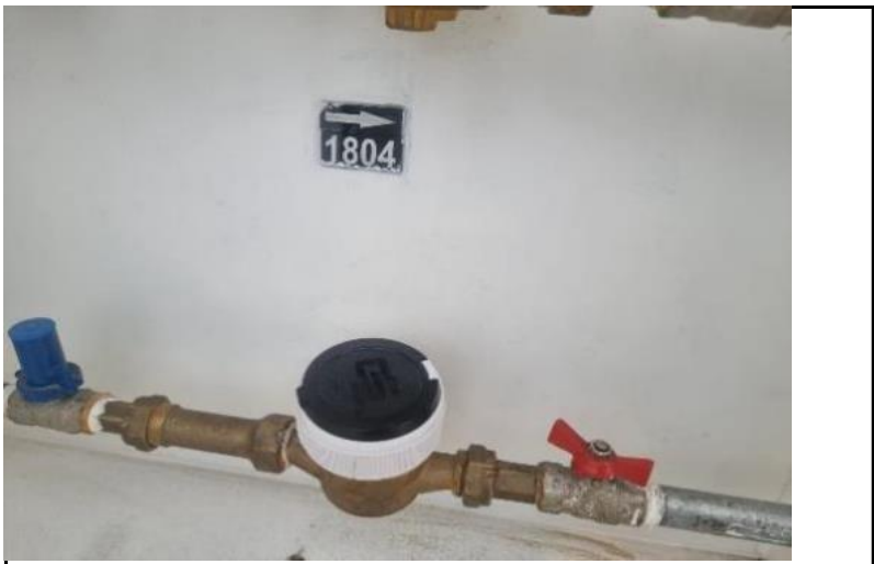
CONTADOR DE ACUEDUCTO
