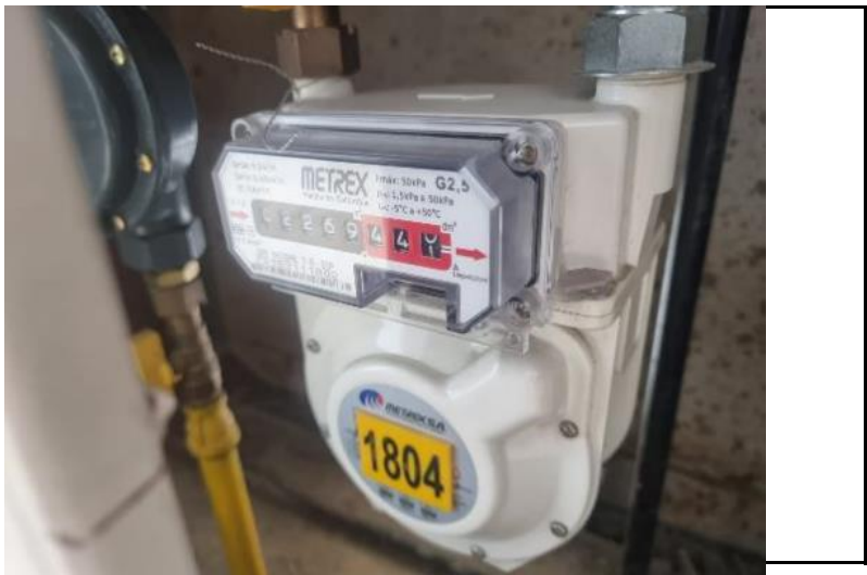
CONTADOR DE GAS NATURAL
