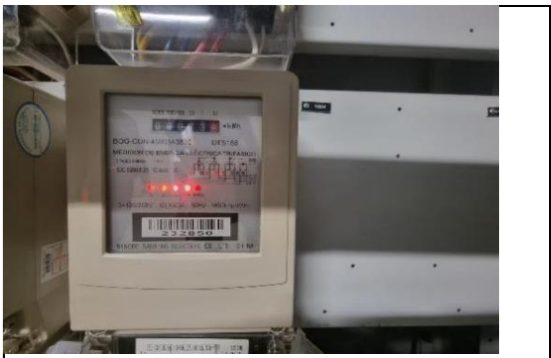
CONTADOR DE ENERGIA ELECTRICA
