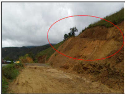
Ronda de coronación no necesaria Km73 + 930 al Km73+980 Nótese el estado de deterioro del talud
