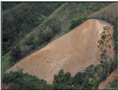
Ronda de coronación no necesaria Km73+100 al Km73+400 Nótese el estado de deterioro del talud
