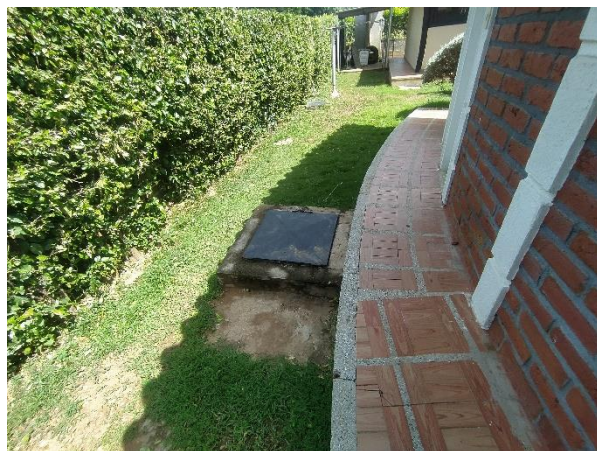
CAJA DE INSPECCION
