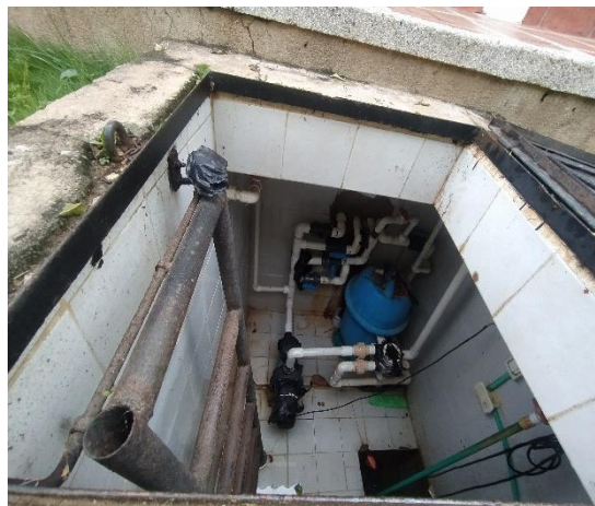
PLANTA DE TRATAMIENTO DE PISCINA
