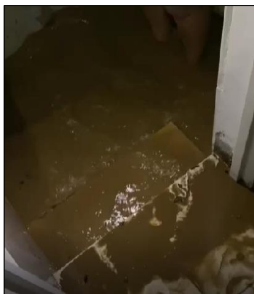
Imagen 7. Retorno de aguas negras (Sanitarias) al interior de las viviendas
