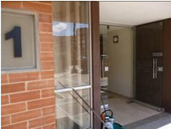
Puerta de acceso a la torre 1 sin señalización
