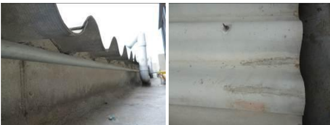
Teja rota frente a los medidores del gas por el costado sur. El apoyo en la cubierta deja de ser homogéneo frente al vacío.
