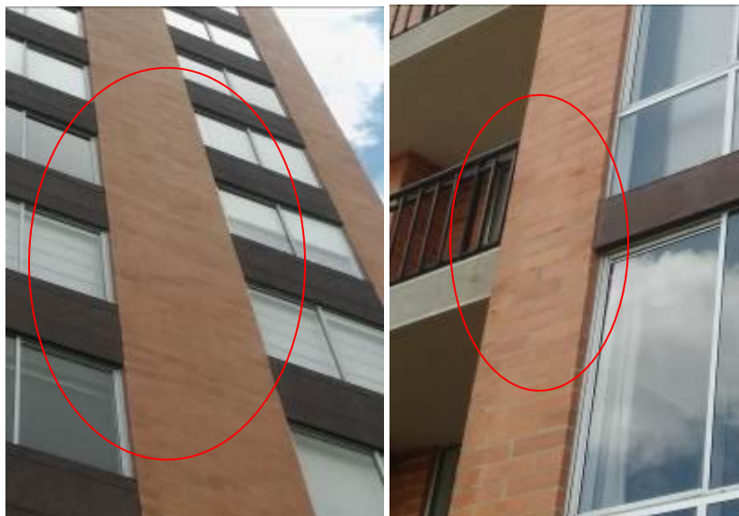
Detalle de meteorización acelerada con delaminación de ladrillo en la fachada posterior costado norte de la torre 1
