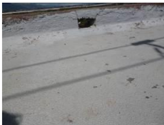
Cubierta cuarto de máquinas. Desagüe en el costado norte muy alto comparado con el nivel de la placa. Situación que permite empozamientos de agua y deterioro acelerado de la impermeabilización.
