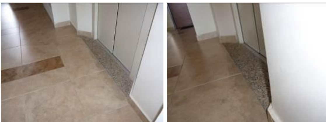
Piso quemado por ácido frente al ascensor piso 10
