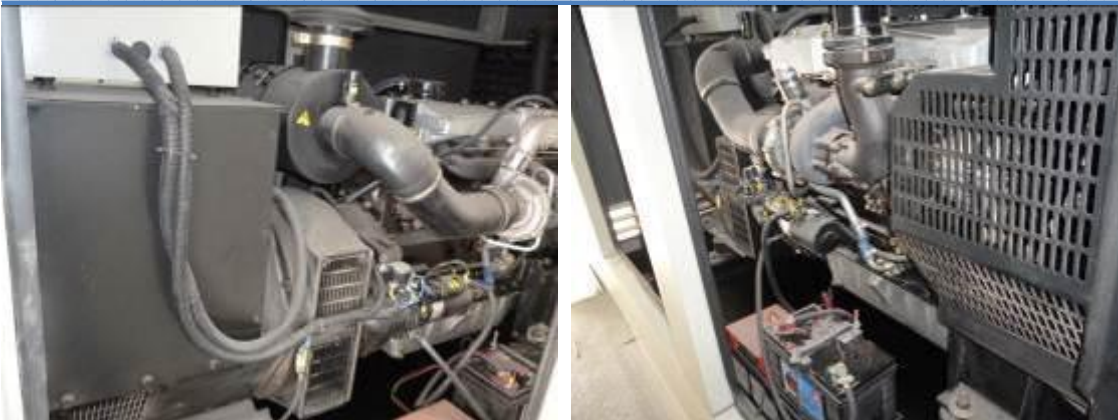
Interior de planta eléctrica con mucho polvo
