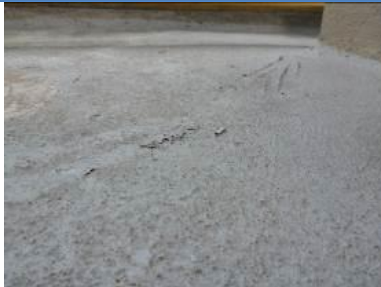
Fallas en la impermeabilización torre 3. En estas fotos se observa como ya en los pliegues se rompió la impermeabilización.
