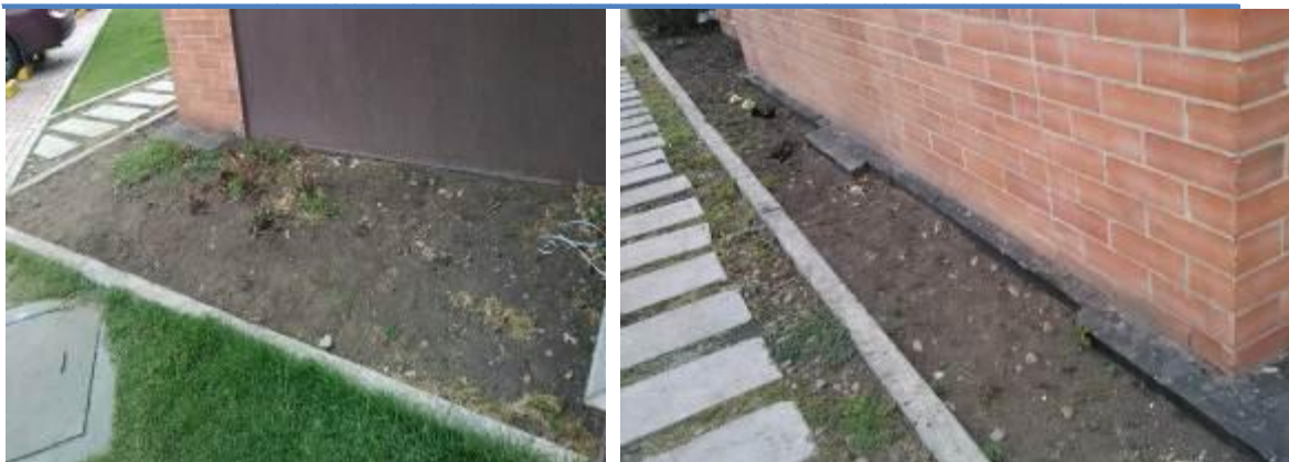
Jardineras ubicadas junto a las torres sin desagües ni filtros
