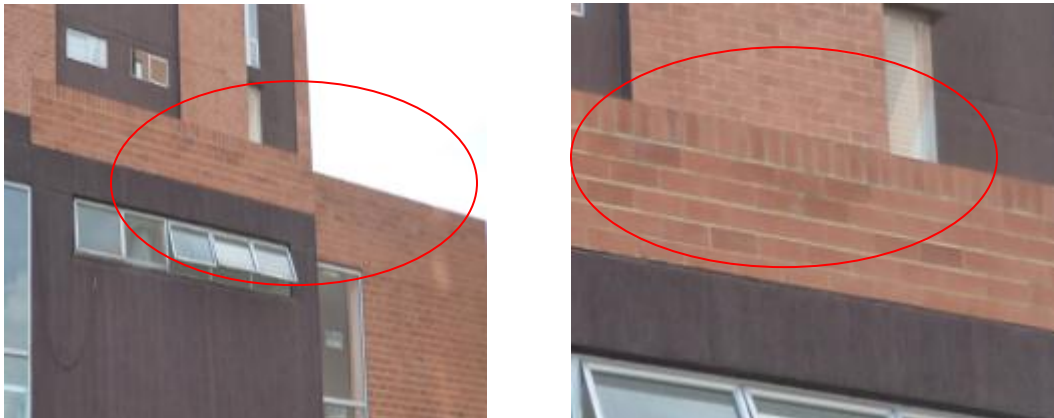
Meteorización acelerada en el muro de remate de cubierta
