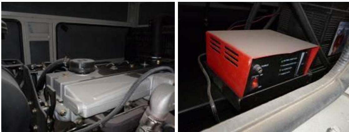
Polvo en el interior de la planta de generación eléctrica.
