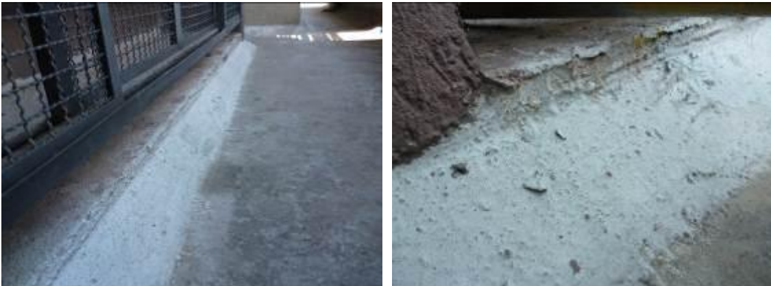
Reparación en la media caña de los medidores de gas. Es evidente la deficiente aplicación del impermeabilizante incluso sobre piedras. El material debe ser aplicado sobre superficies bien afinadas y estas condiciones no garantizan la estabilidad de la impermeabilización.
