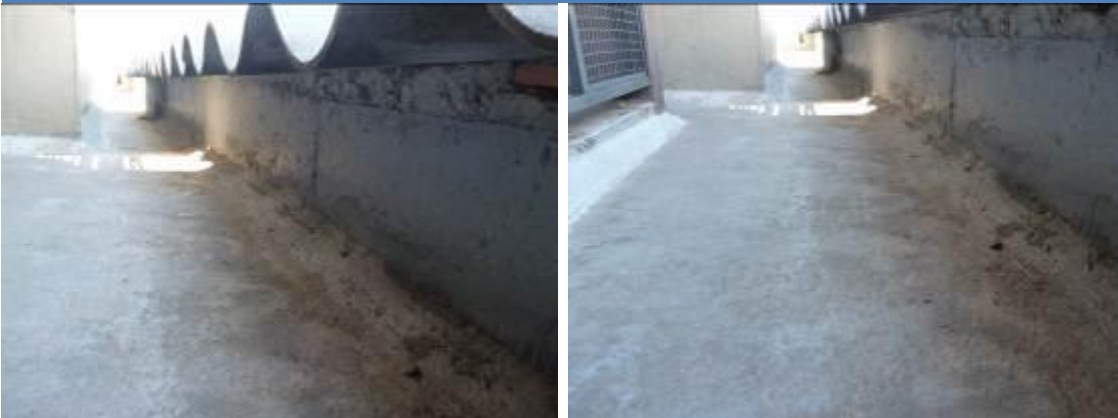
Media caña frente a los medidores de gas torre 2. Material aplicado con pliegues y sobre una superficie rugosa.
