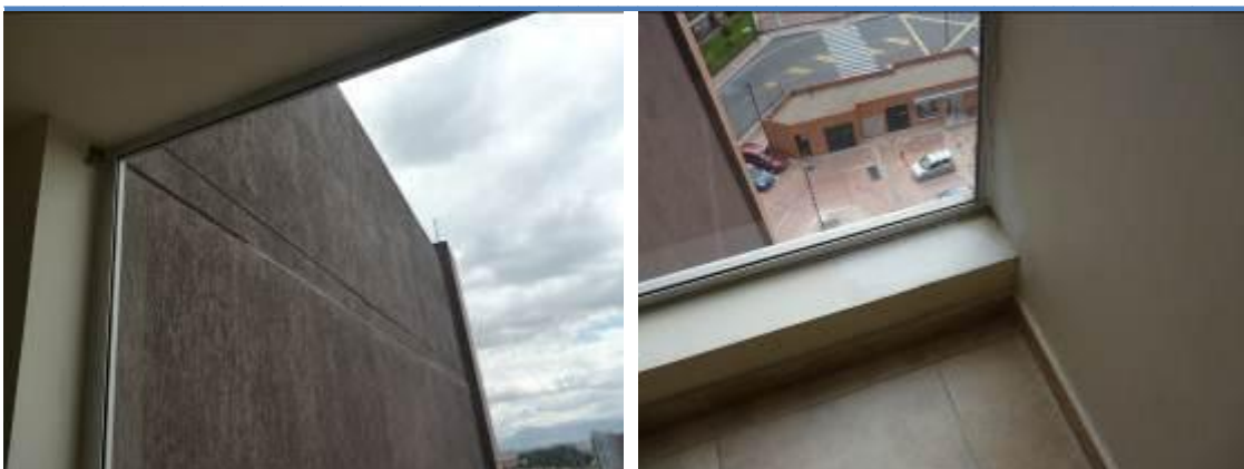
Ventanas sin gotero que permiten la filtración de agua al interior de la torre 3
