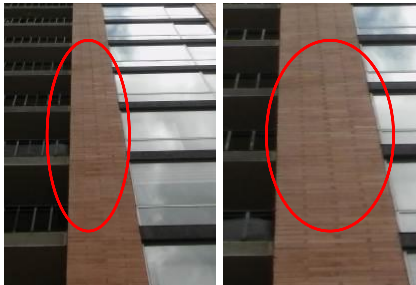
Ladrillo fachada occidental torre 1 piso 5 a piso 12 deterioro por meteorización acelerada
