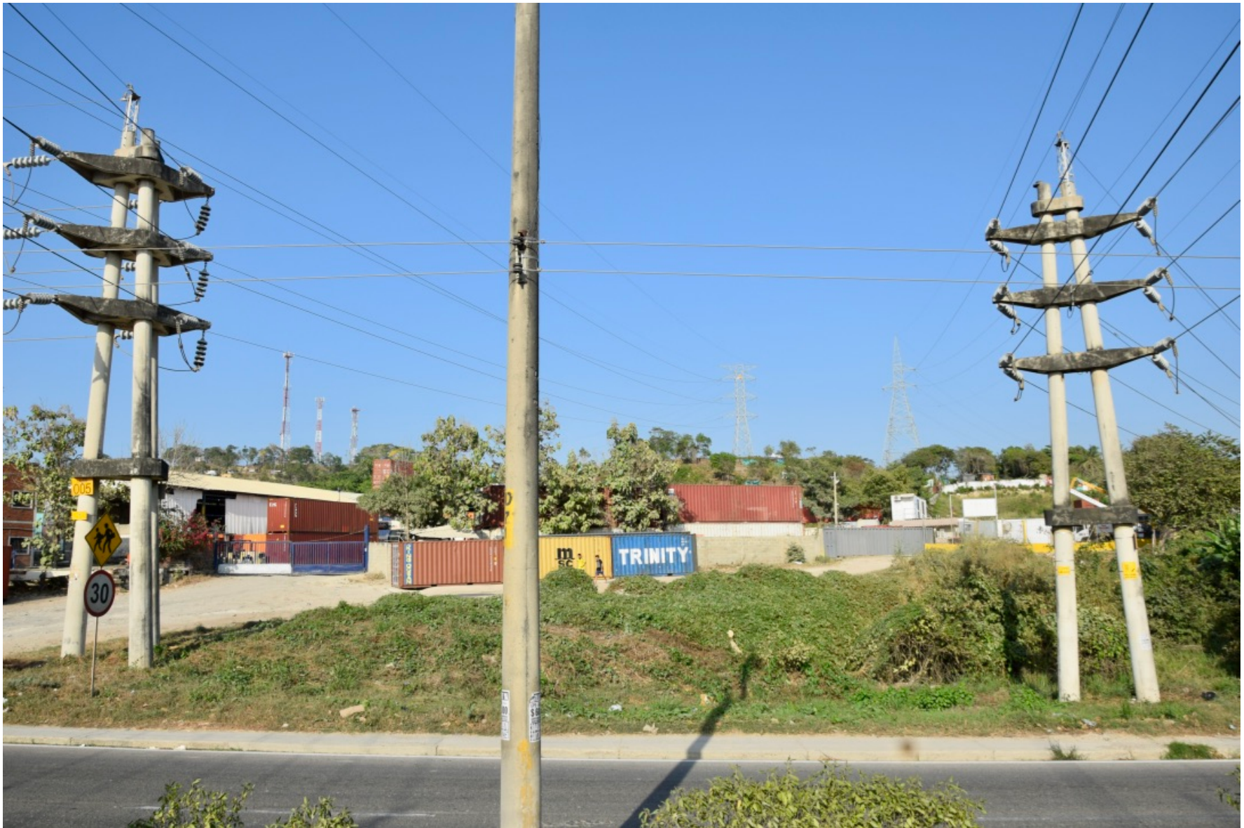
Líneas eléctricas de mediana y alta tensión, cuyas redes generan cuatro servidumbres que cruzan por encima del terreno objeto de controversia.
