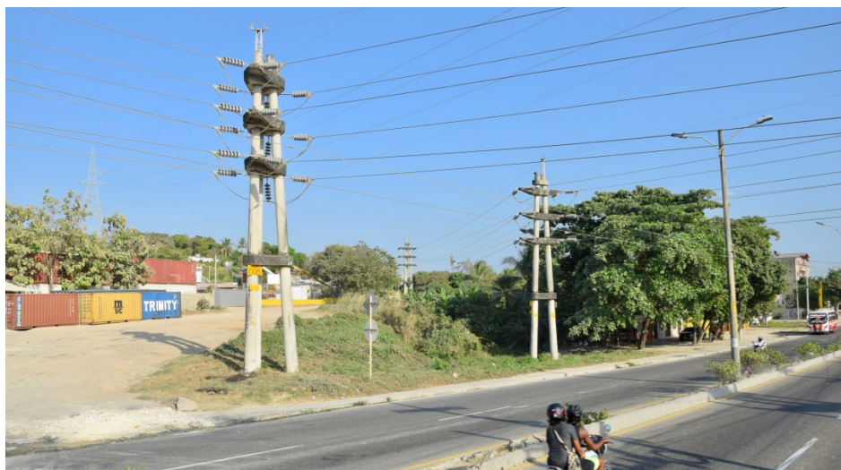
Zona donde se ubican las torres de energía de mediana tensión.
