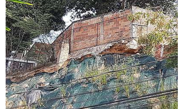
Construcciones próximas al borde superior.
