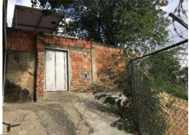
Construcciones próximas al borde superior.
