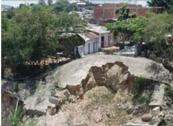
Construcciones próximas al borde superior.
