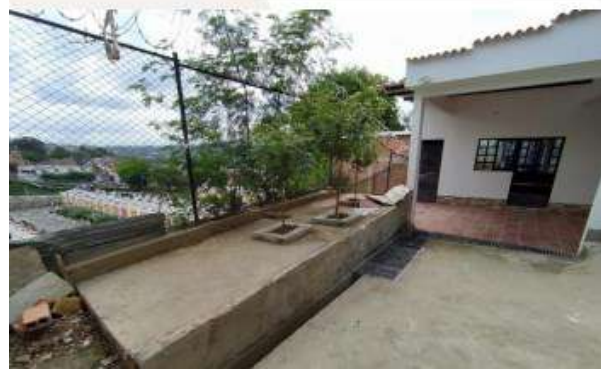
Construcciones próximas al borde superior.
