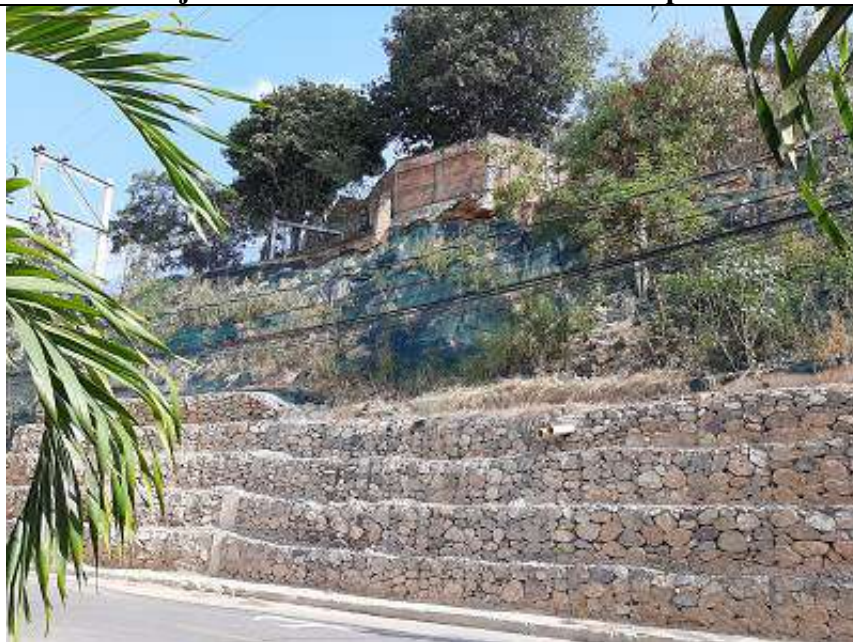
Ruptura de tubería de agua potable en el cuerpo del talud
