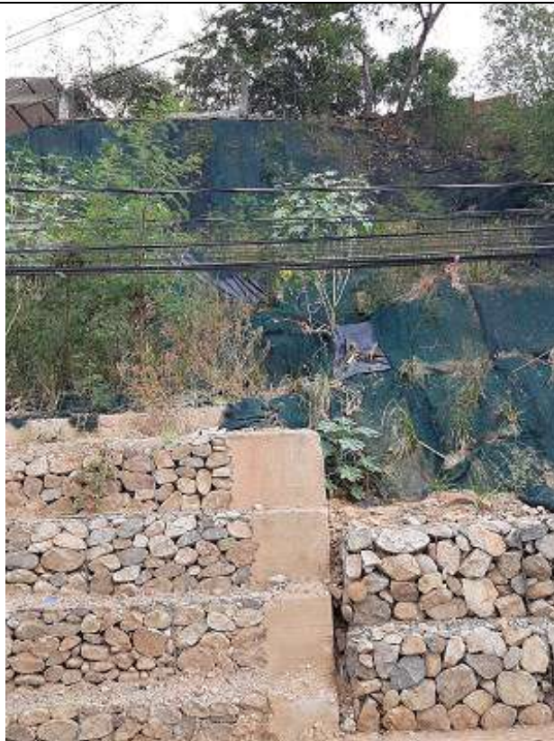
Deslizamiento junto a la Avenida 23 en el borde superior del talud.
