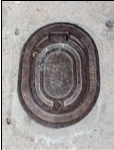
MEDIDOR DE AGUA
